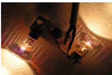
Σχήμα 2.11.: Ηλεκτρικά "σποτ" 50 W
