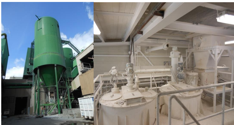
Εικόνα 25 . Πύργος έκπλυσης και εγκατάσταση προετοιμασίας υδράσβεστου
