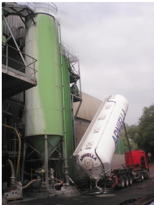
Εικόνα 32. Σιλό αποθήκευσης Bicar SB 0/3 κατά την περίοδο των δοκιμών
