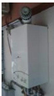
Εικόνα 7:Ατομικός επίτοιχος λέβητας αερίου
