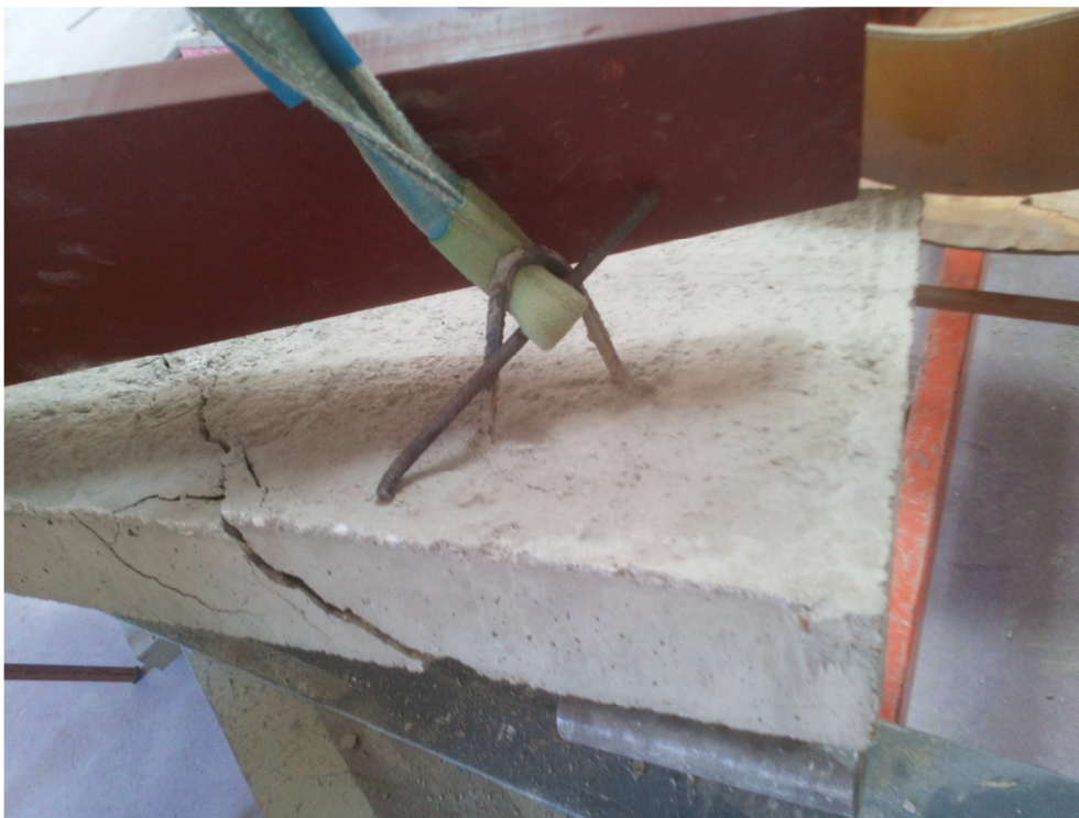
Σχήμα 2.27 Αστοχία στα άκρα της πλακοδοκού
