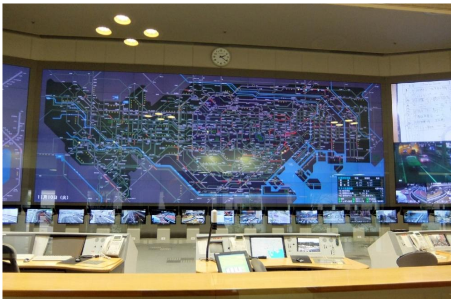
Εικόνα 22. Κεντρικός έλεγχος κυκλοφορίας της πόλης του Tokyo.
