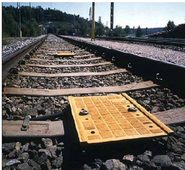
Εικόνα 21. Ραδιοφάροι της εταιρείας Adtranz. Ο πρώτος χρησιμοποιείται για τον έλεγχο της θέσης του τρένου και ο δεύτερος για τη μετάδοση των δεδομένων.
