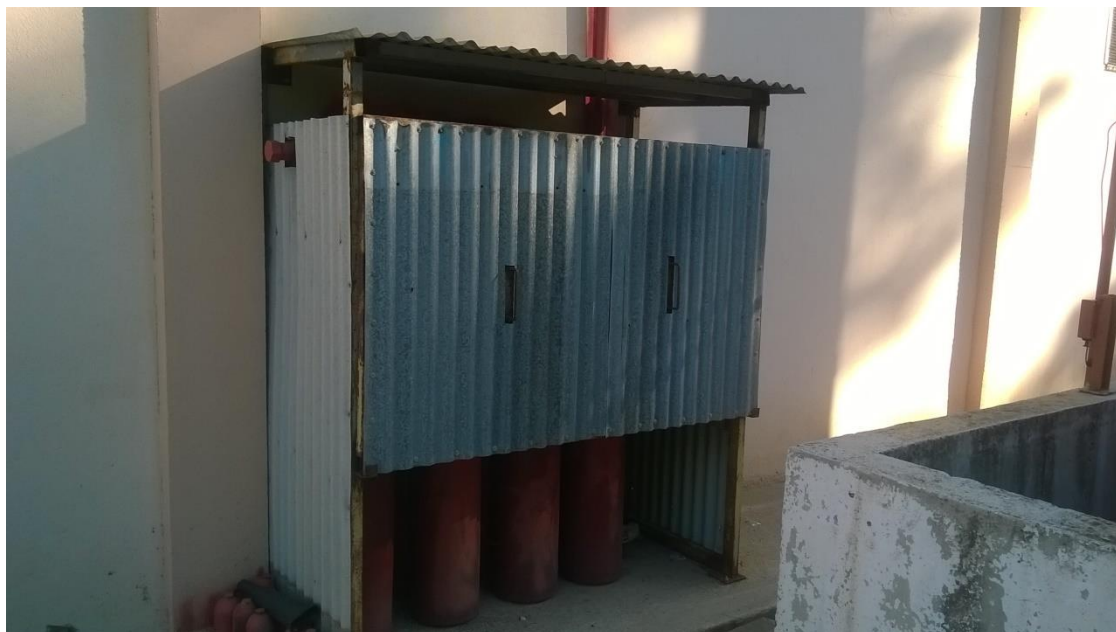
Εικόνα 46 Σύστημα πυρόσβεσης με CO2
