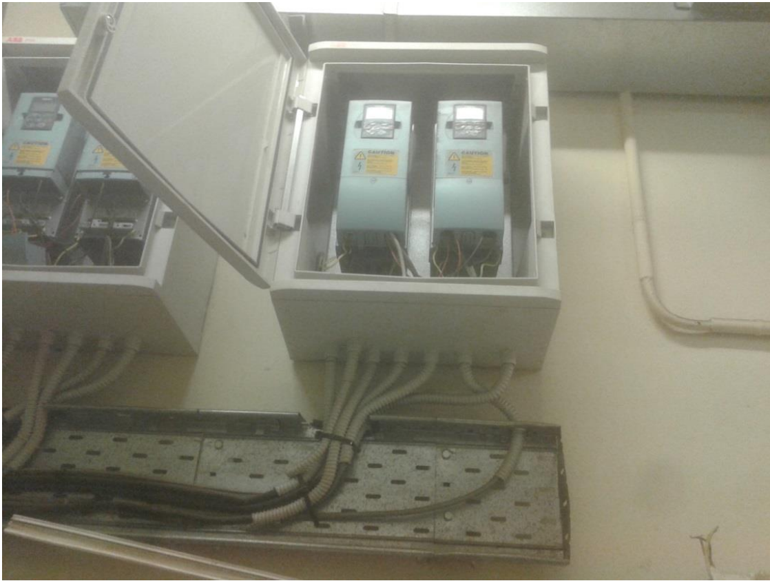
Εικόνα 65 Inverter κινητήρων ταινιών
