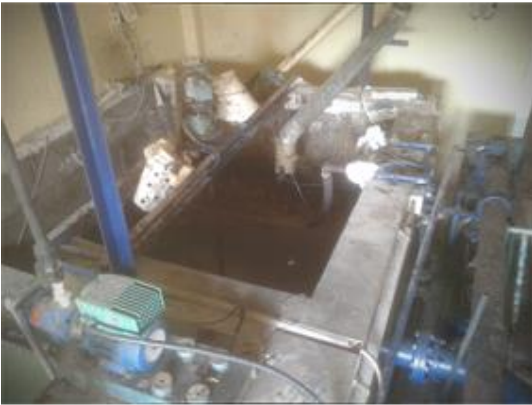
Εικόνα 59 Δεξαμενή ανάδευσης πολυμερούς
