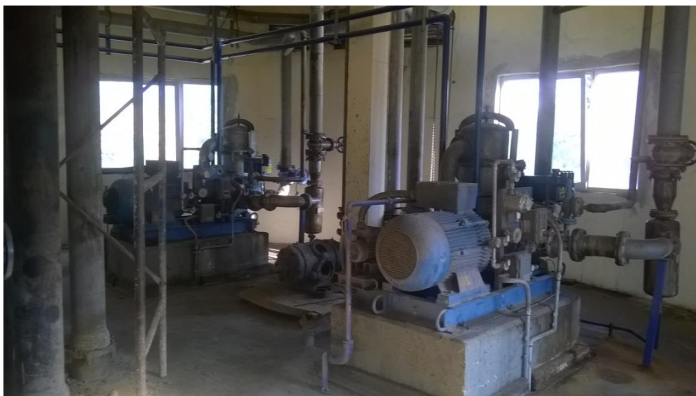
Εικόνα 41 Χώρος συμπιεστών μεθανίου
