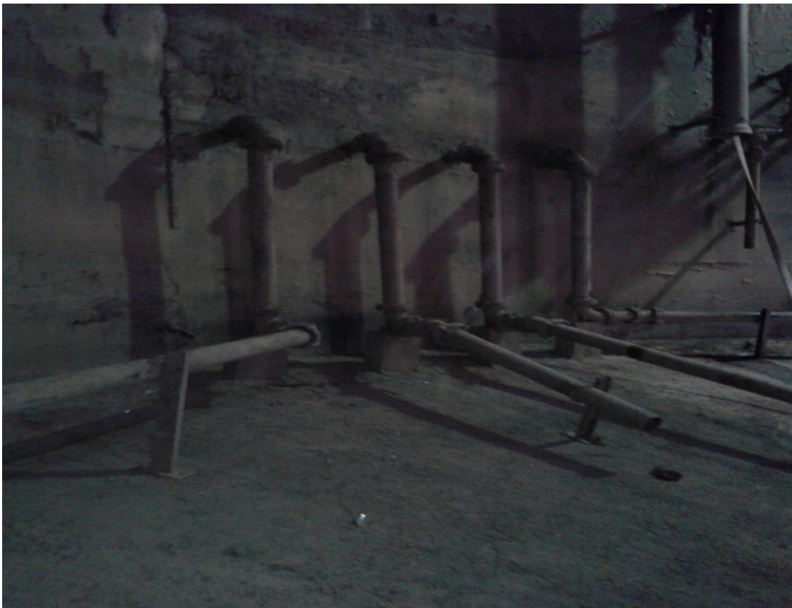
Εικόνα 40 Σωληνώσεις αναρρόφησης αντλιών φιλτροπρεσών από το stocker
