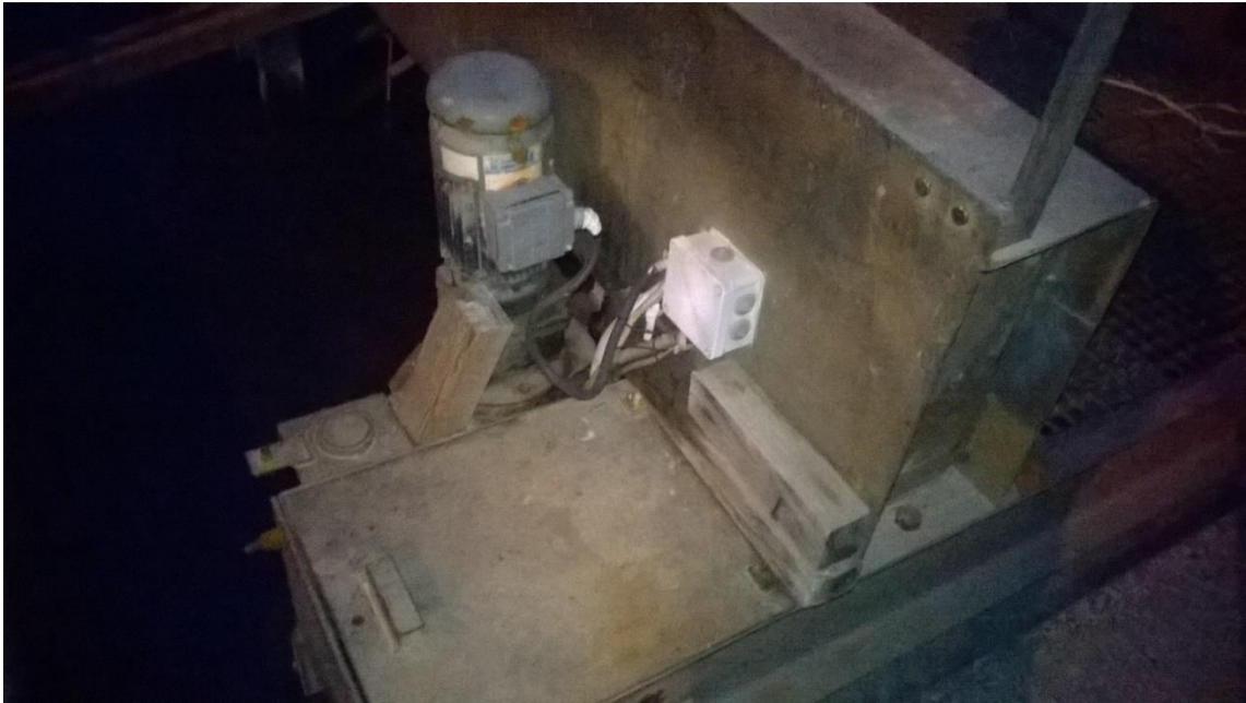
Εικόνα 54 Κινητήρας κίνησης γέφυρας
