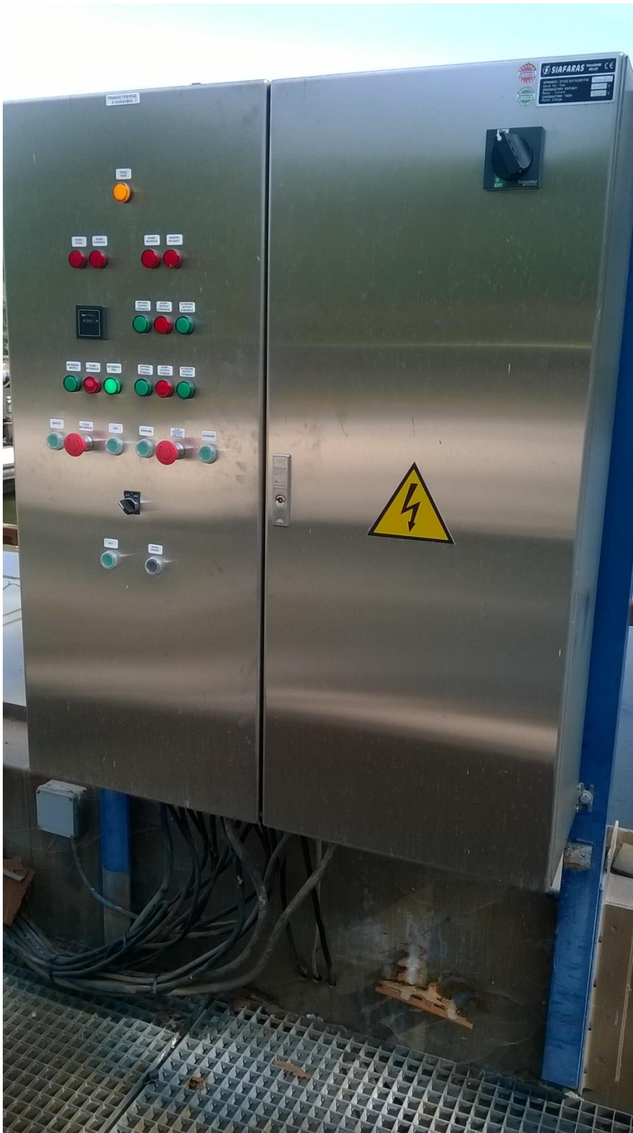
Εικόνα 53 Πίνακας λειτουργίας γέφυρας
