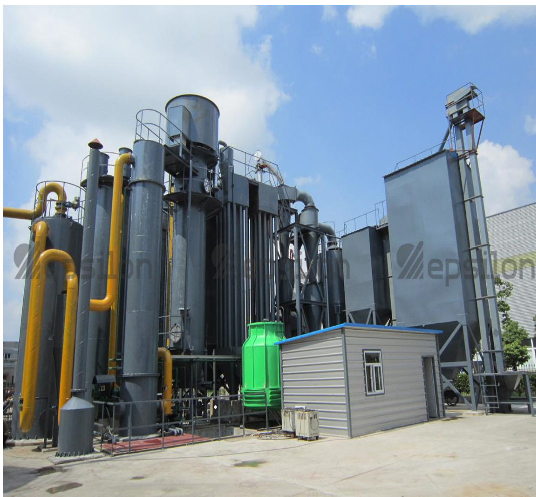
Εικόνα 26: Μονάδα βιομάζας ισχύος 500 kW
