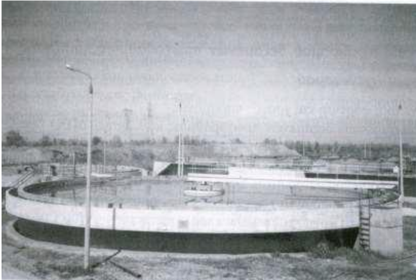
2.6 Δεξαμενή πρωτοβάθμιας καθίζησης ΜΕΥΑ Λάρισας.. ΠΗΓΗ: Χατζούλης Γ. Μελίδης Γ., Πτυχιακή εργασία, Καβάλα Απρίλιος 2010
