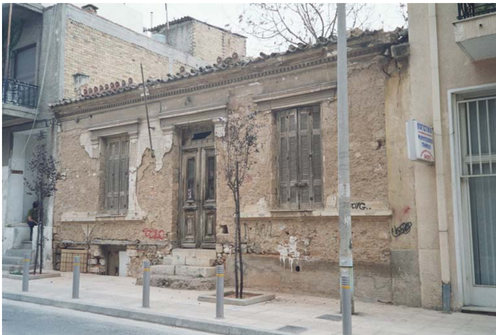
Εγκαταλελημένο στην οδό Δημοφώντος
