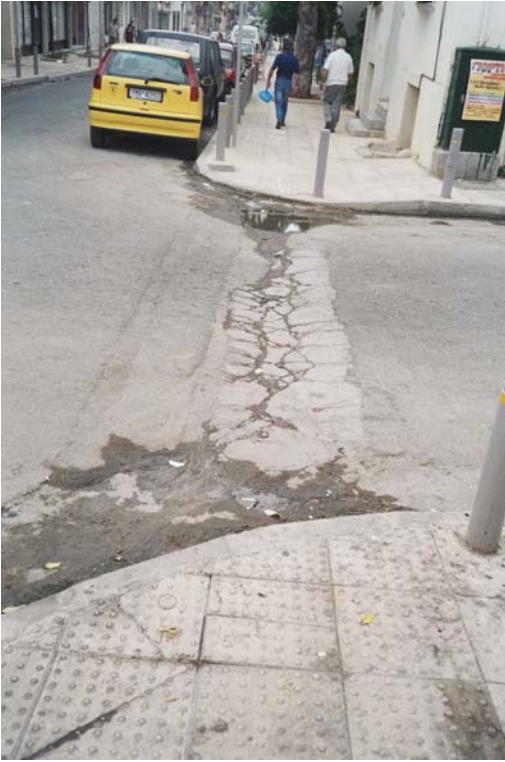
Οδόστρωμα με λακούβες επί της οδού Θορικών
