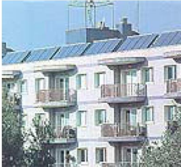
Σχήμα 2.4: Φωτοβολταϊκός Σταθμός Παραγωγής σε στέγη οικίας
