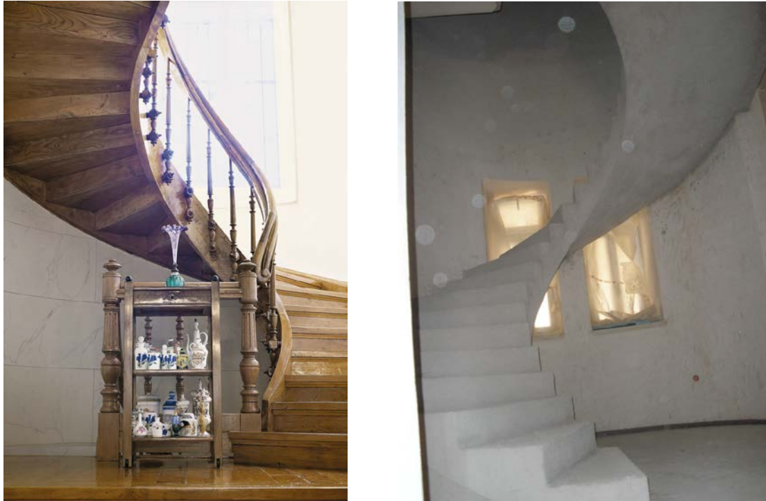
Εικ.42 Αντικατάσταση παλαιάς ξύλινης νεοκλασικής σκάλας με τσιμεντένια. Συναντάμε αρκετές φορές τέτοιου είδους αντικατάσταση για οικονομικούς κυρίως λόγους.
