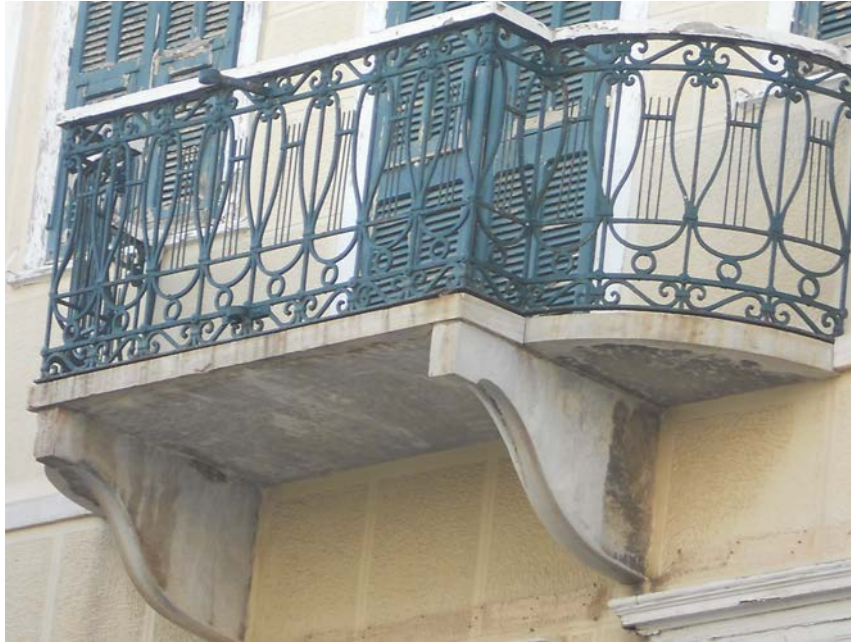
Εικ.28 Μαρμάρινο μπαλκόνι, με τμήματα τεταρτοκύκλιου στις δύο άκρες, κάγκελα σε σχήμα λύρας και απλά φουρούσια.
