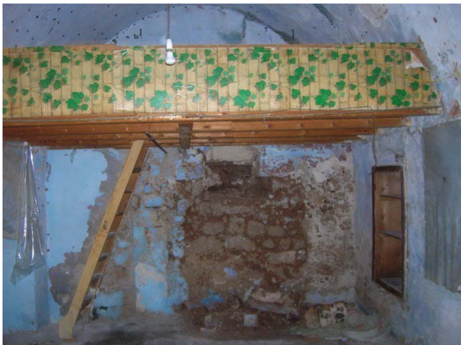
Φωτ. 18 : Φθορές στα εσωτερικά επιχρίσματα του δωματίου «12»
