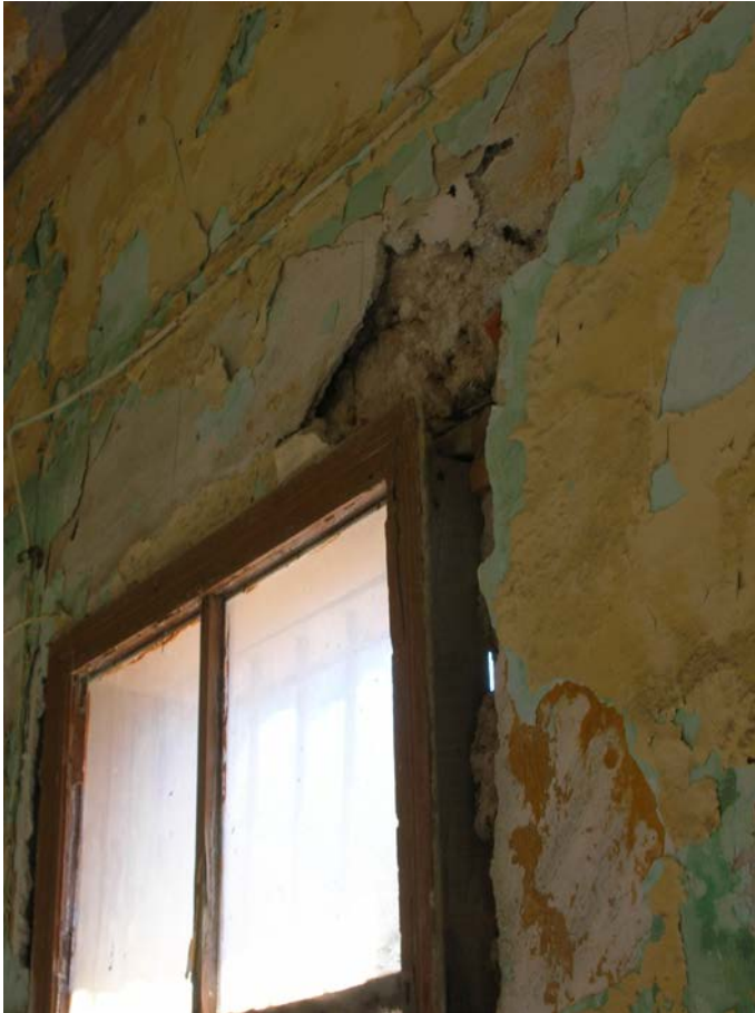
Φωτ. 20 : Αποκόλληση παραθύρων από τοιχοποιία στον διάδρομο Α' ορόφου
