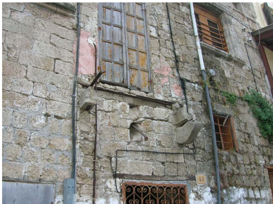
Φωτ. 29 : Λεπτομέρεια υπολείμματος εξώστη επί της προσόψεως της οδού Θησέως ιδιοκτησίας Δωροθέας Μαυράκη
