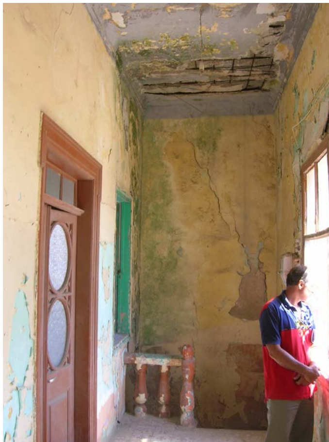
Φωτ. 12 : Αποκόλληση ανατολικού τοίχου από την πρόσοψη – Διαβρωμένοι οπλισμοί οροφής διαδρόμου Α' ορόφου
