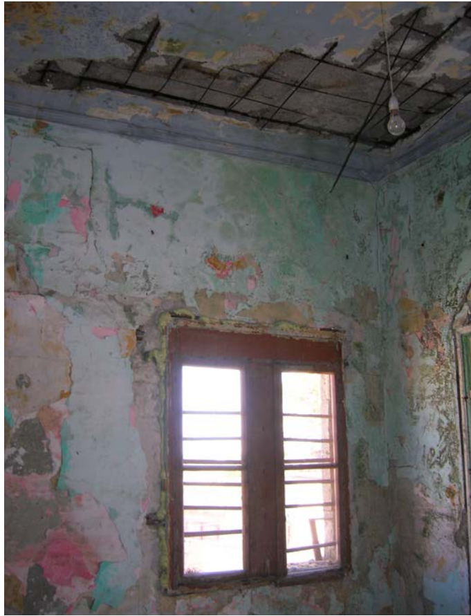
Φωτ. 21: Πλήρης καταστροφή από διάβρωση του οπλισμού
