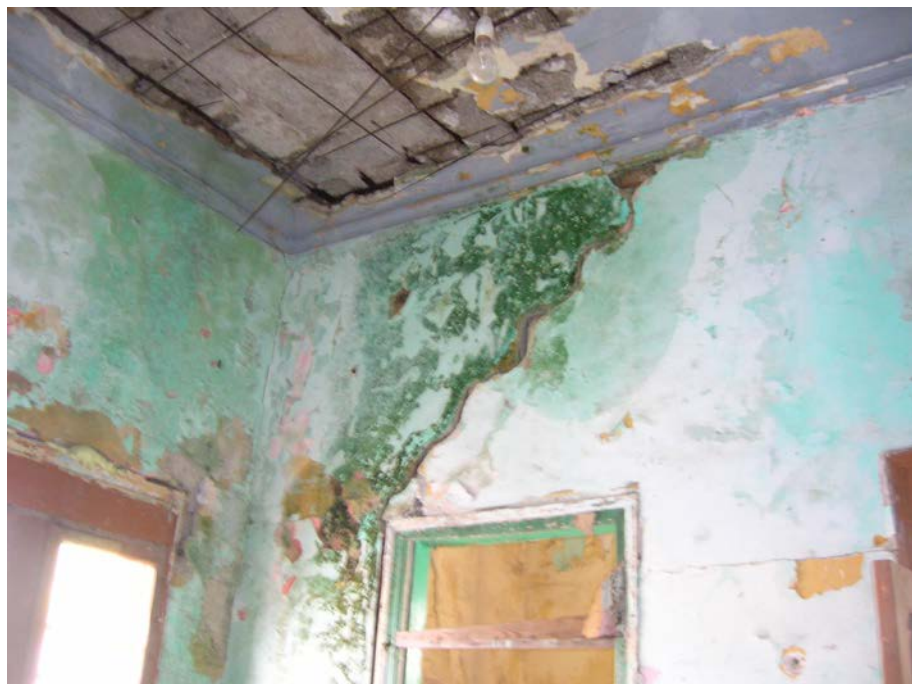
Φωτ. 22 : καταστροφή οπλισμού - αποκόλληση τοίχου προσόψεως – διαπερατή οροφή – σημαντική υγρασία στο δωμάτιο «Α1»
