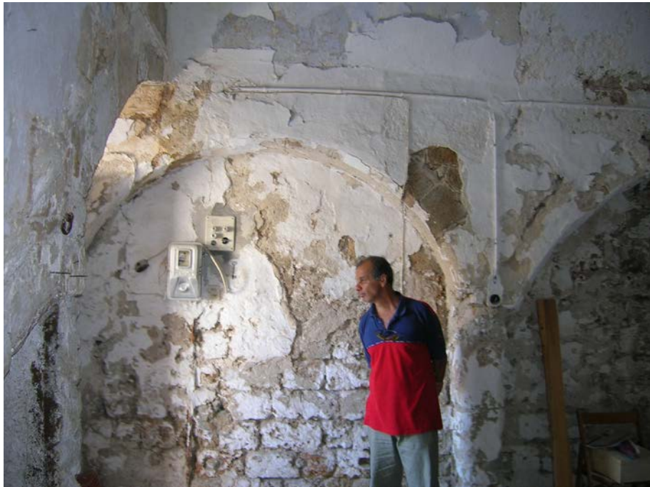
Φωτ. 17 : φθορές στα εσωτερικά επιχρίσματα του δωματίου «11»
