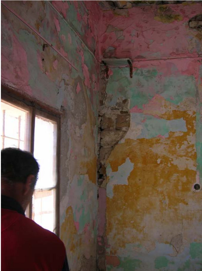
Φωτ. 25 : Αποκόλληση ανατολικού τοίχου στο δωμάτιο «Α3»
