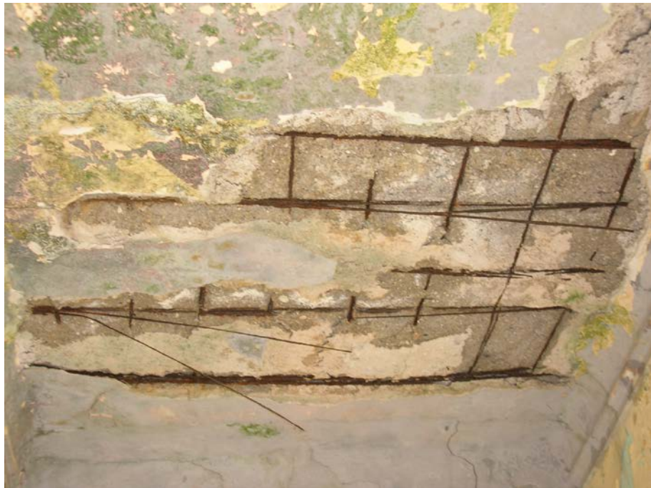
Φωτ. 19 : Λεπτομέρεια διαβρώσεως οπλισμού οροφής διαδρόμου Α' ορόφου
