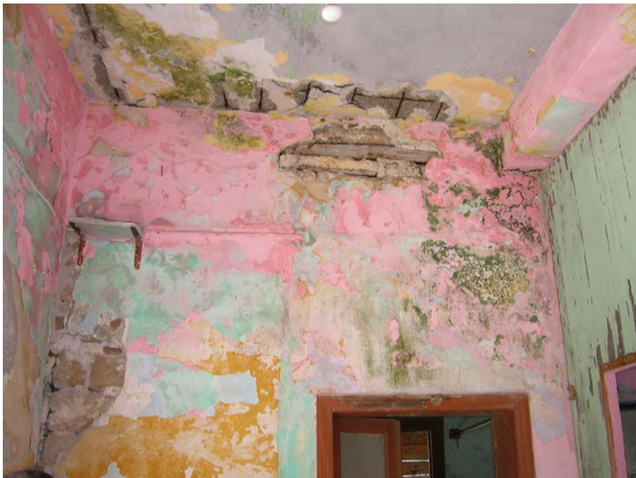
Φωτ. 24 : Φθορές στο δωμάτιο Α3
