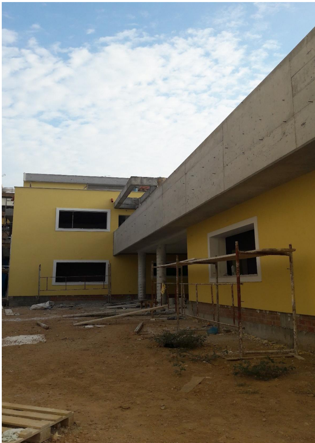
Εικ.5 Ολοκλήρωση οικοδομικών εργασιών του βρεφονηπιακού σταθμού επί των οδών Π. Ράλλη, Κομνηνών & Αχιλλέως στη Νίκαια
