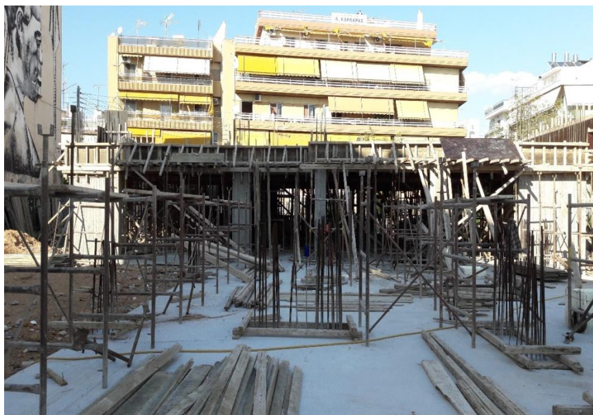
Εικ.3 Σκυροδέτηση ισογείου για την ανέγερση του βρεφονηπιακού σταθμού επί των οδών Π. Ράλλη, Κομνηνών & Αχιλλέως στη Νίκαια
