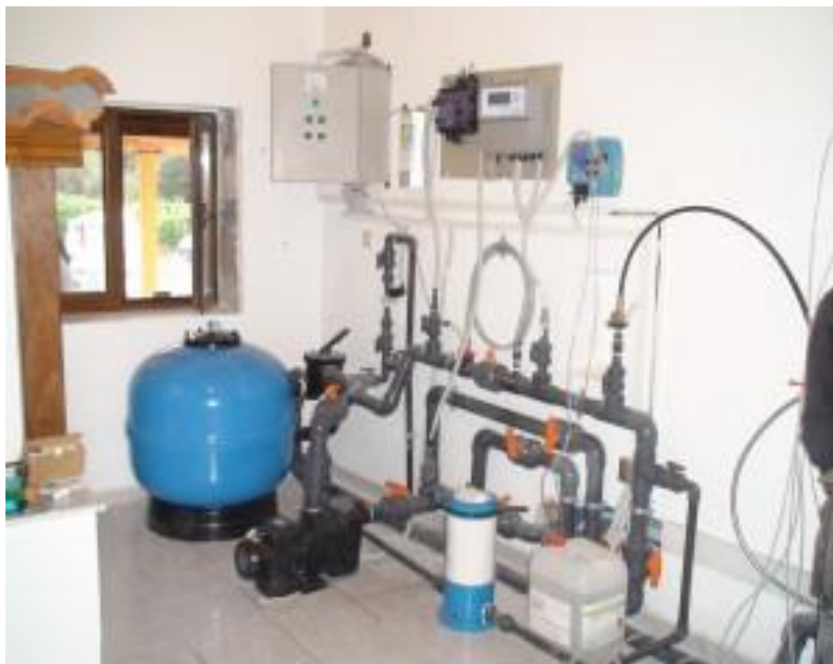
Εικόνα 3.25 Εγκατάσταση δοσομετρικού συστήματος από την ClearWater
