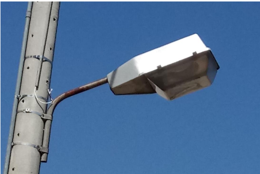
Εικόνα 3.24 Φωτιστικό σώμα στα 5 μέτρα, τύπου semi cutoff, σε στύλο της ΔΕΗ, περιμετρικά της πλατείας Μουστακλή, με φωτεινή πηγή Na 150 Watt
