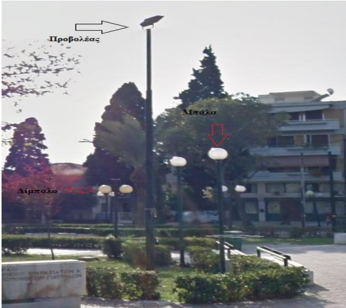
Εικόνα 3.25 (α) Φωτιστικά σώματα στα 3μέτρα, τύπου Non cutoff, σε κλασικό στύλ «Δίπαλο, Μπάλα», με φωτεινή πηγή CFL 23 Watt και (β) προβολέας στα 5μέτρα, με φωτεινή πηγή HQI, 150 Watt επί της πλατείας Μικρασιατών.
