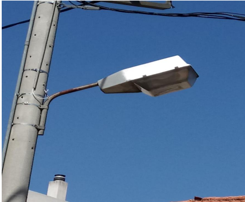
Εικόνα 4.23 Φωτιστικό σώμα στα 5 μέτρα, τύπου semi cutoff, σε στύλο της ΔΕΗ. Φέρει μία φωτεινή πηγή Na 250 Watt. Χρησιμοποιείται από το Δήμο για το φωτισμό δρόμου
