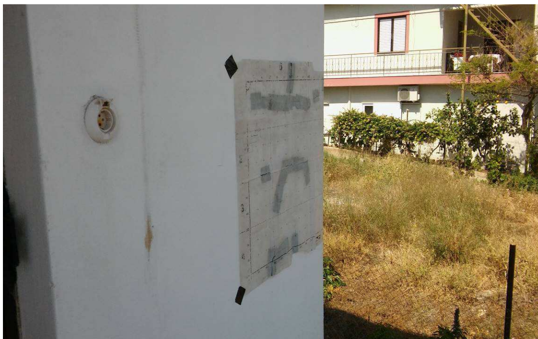
Εικόνα 37. Μembrάνη αποτύπωσης οπλισμού στο K10
