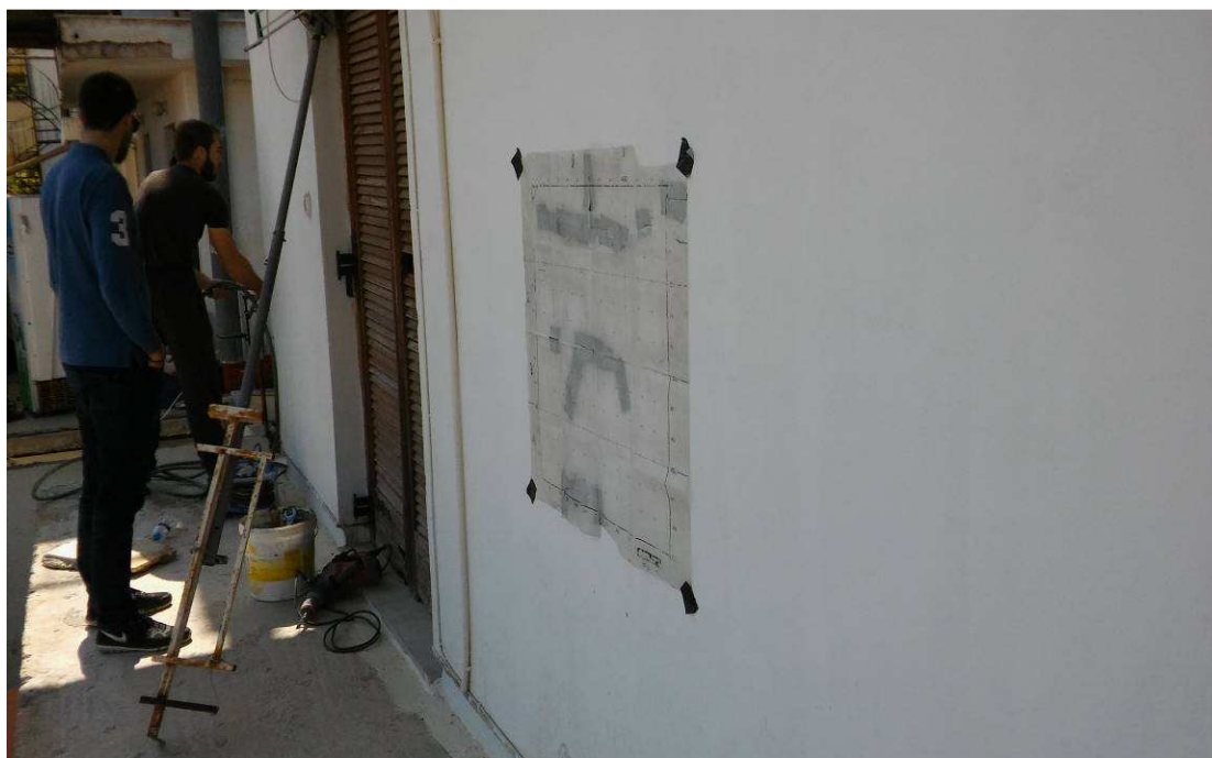
Εικόνα 39. Μembrάνη αποτύπωσης οπλισμού στο K11
