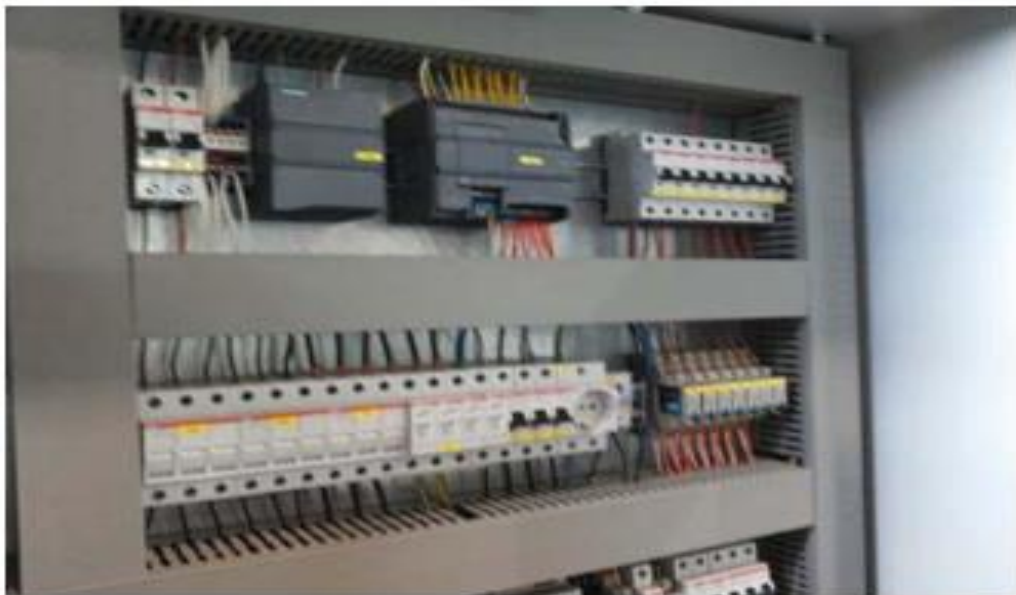
Εικόνα 1.4: Πίνακας Αυτοματισμού με PLC
