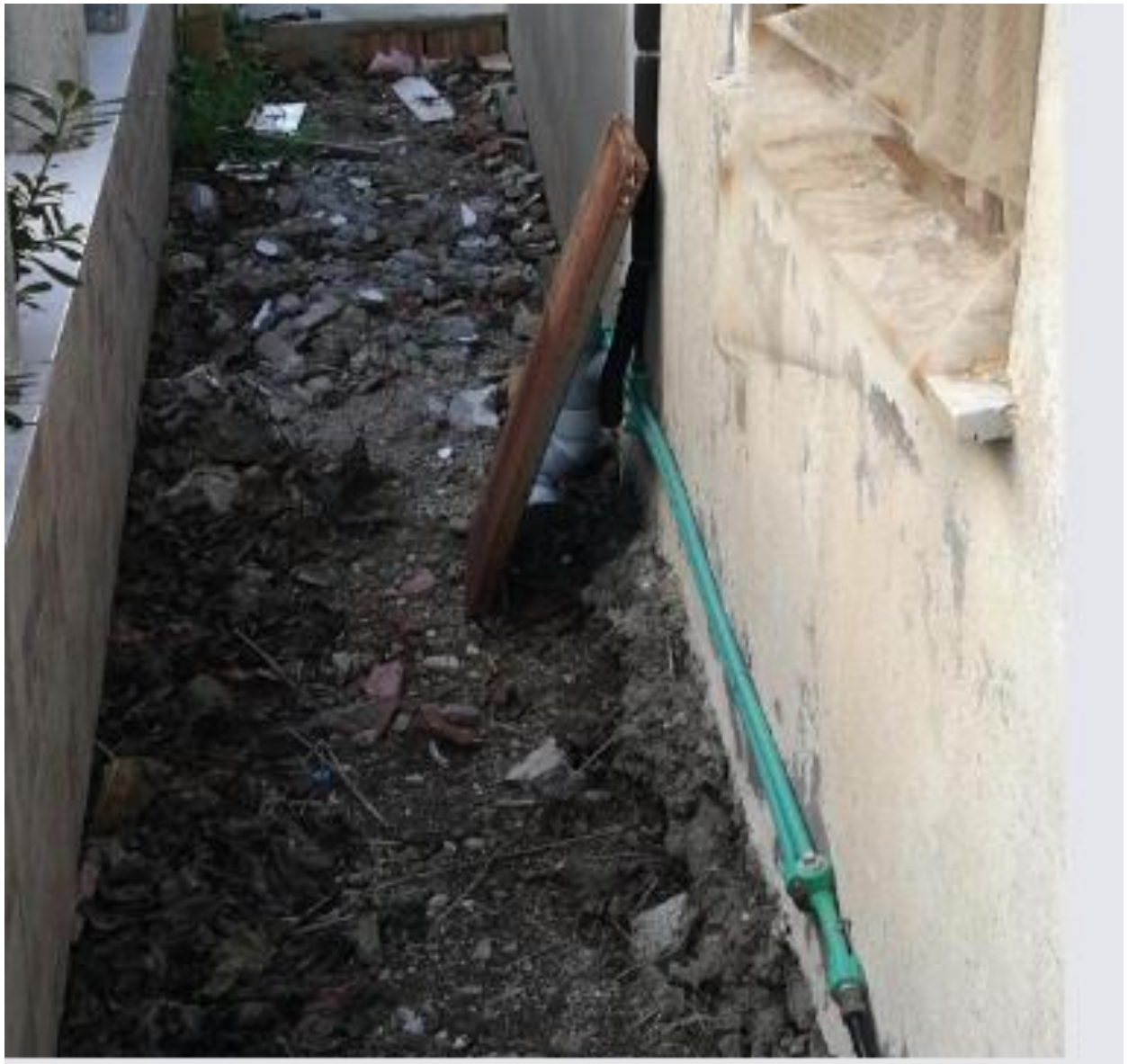
Εικόνα 19: Αυθαίρετος βόθρος σε κατοικία (3). Πηγή: φωτογράφιση ίδιας.
