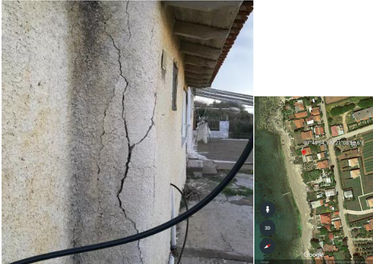
Εικόνα 4: Ρωγμές σε αυθαίρετη κατασκευή (2). Πηγή: φωτογράφιση ίδιας . Τοποθέτηση “πινέζας τοποθεσίας” όπου έχουν τραβηχτεί οι φωτογραφίες. Πηγή: Google Maps
