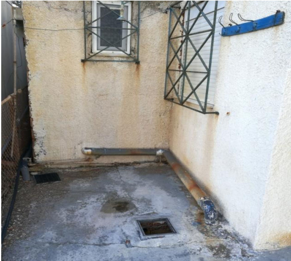
Εικόνα 18: Αυθαίρετος βόθρος σε κατοικία (2). Πηγή: φωτογράφιση ίδιας.
