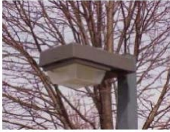
Σχήμα 112. Φωτιστικό σώμα χώρου στάθμευσης.
