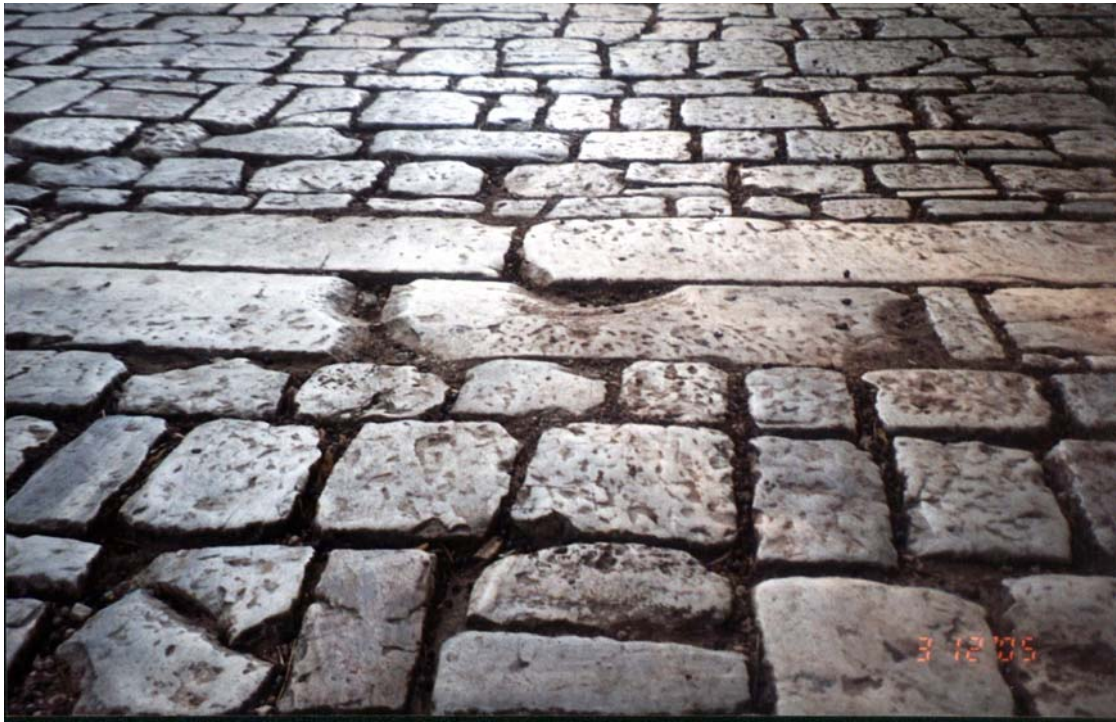
Εικόνα 33. Φθορές στο πλακόστρωτο της διαδρομής προς το Άνδηρο
