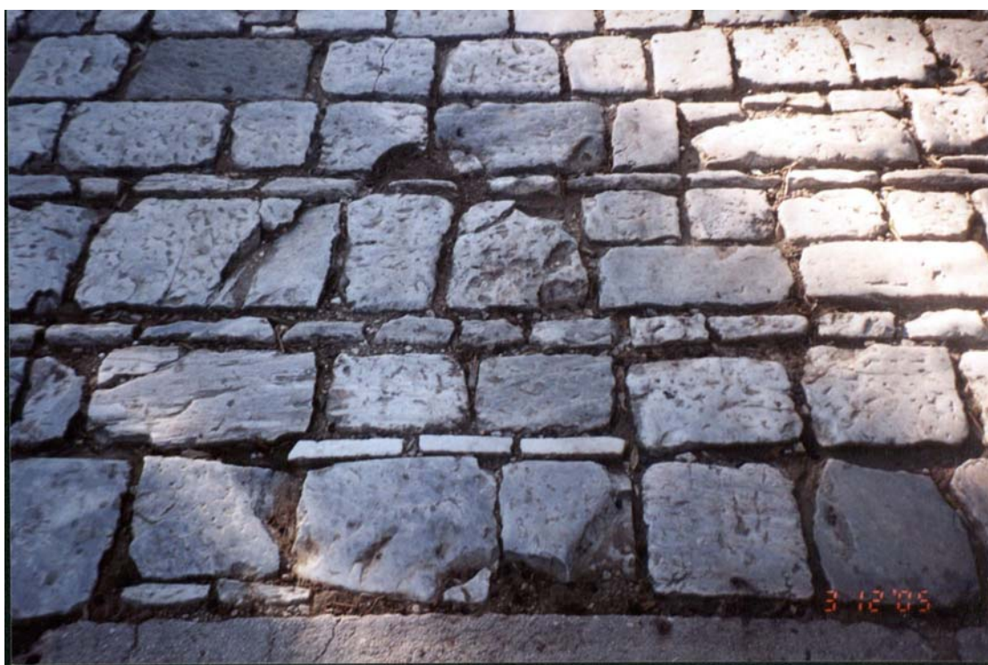
Εικόνα 32. Φθορές στο πλακόστρωτο της διαδρομής προς το Άνδηρο
