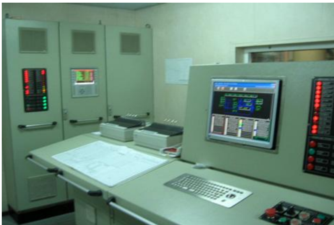
Εικόνα 6. Δωμάτιο ελέγχου - PLC πλοίων
