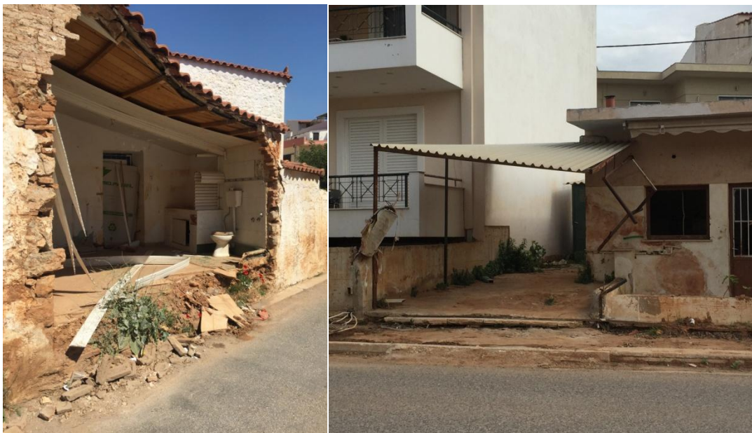
Εικόνα 52 Κατεστραμμένα κτήρια, λόγω παλαιότητας και κακής συντήρησης
