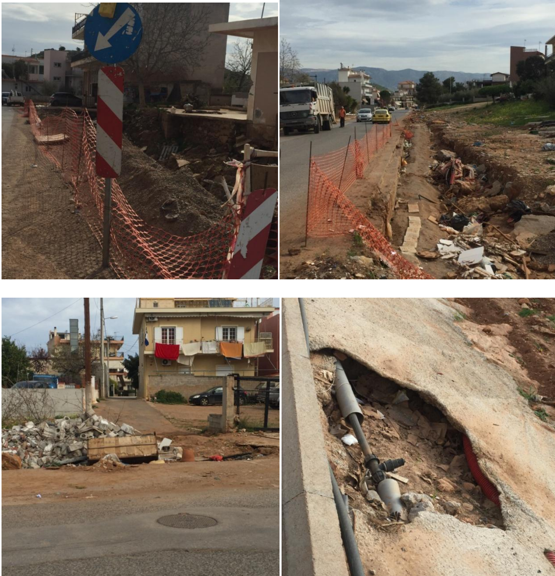
Εικόνα 41 Στοιχεία κακοτεχνίας οδικού δικτύου
