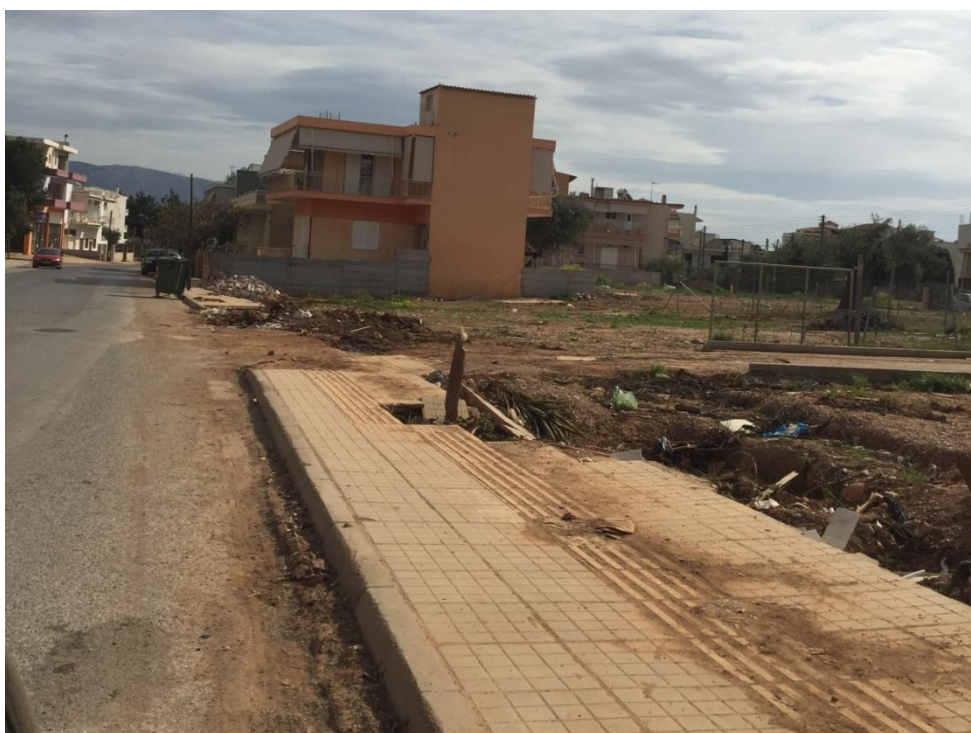
Εικόνα 30 Στοιχεία κακοτεχνίας οδικού δικτύου
