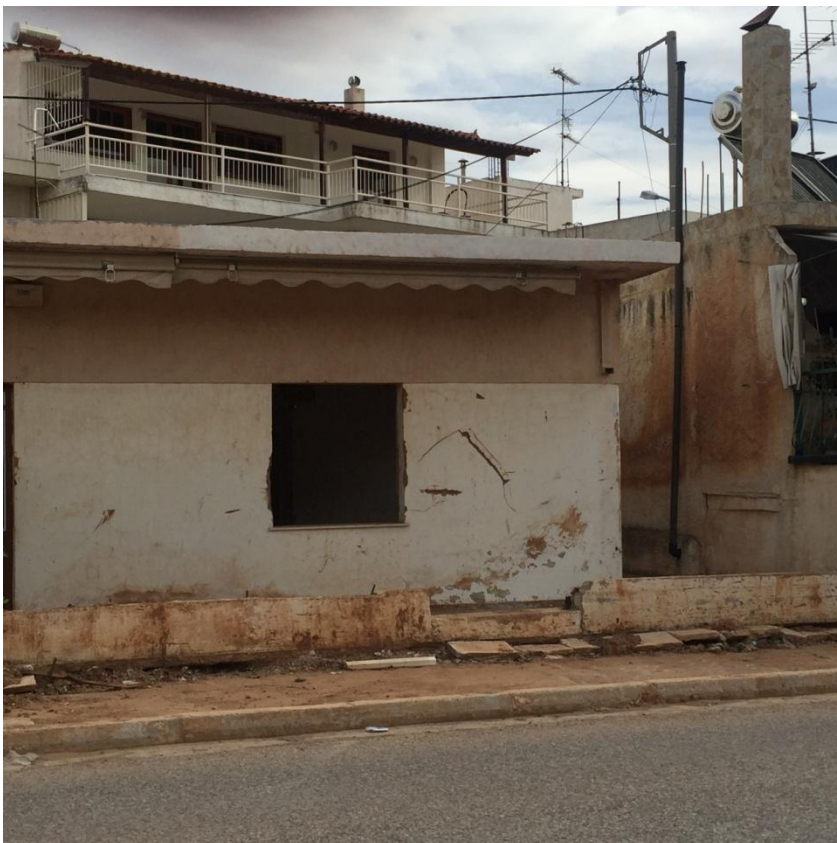
Εικόνα 51 Στοιχεία εγκατάλειψης παρατηρούνται σε αρκετούς ισόγειους χώρους κτιρίων πιθανώς και λόγω των πλημμύρων που πλήττουν την περιοχή Πηγή : Προσωπικό αρχείο μελετητών
