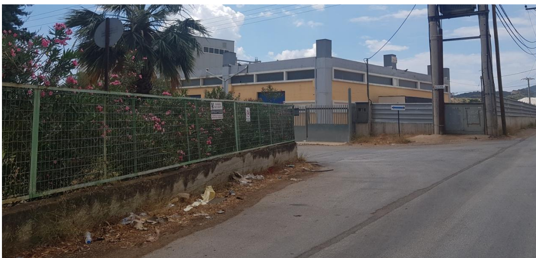
Εικόνα 14 Κακοτεχνίες στο οδικό δίκτυο της ΒΙΠΕ (Προσωπική λήψη)
