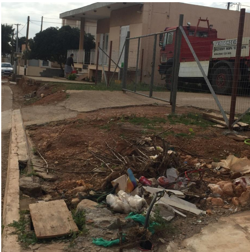
Εικόνα 36 Στοιχεία κακοτεχνίας οδικού δικτύου
