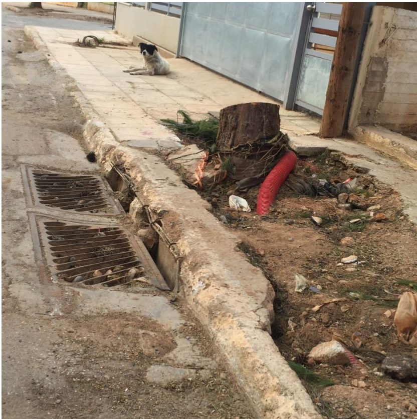
Εικόνα 40 Στοιχεία κακοτεχνίας οδικού δικτύου
