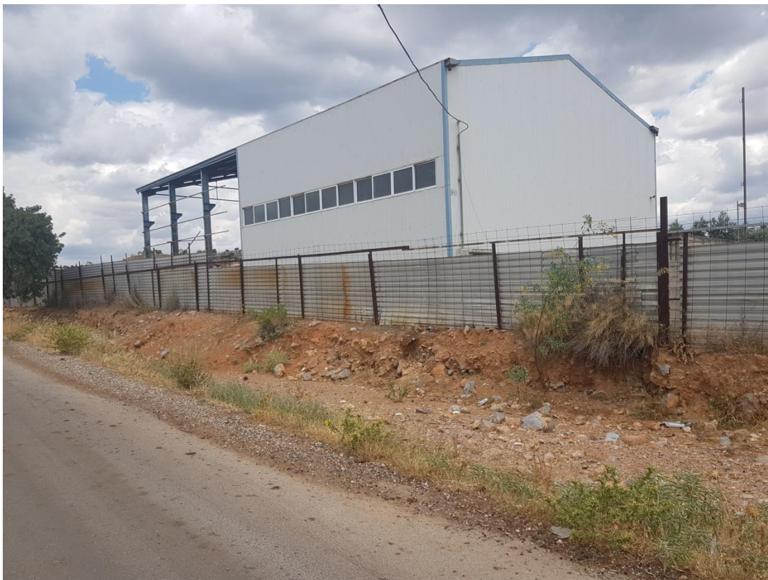
Εικόνα 16 Κακοτεχνίες στο οδικό δίκτυο της ΒΙΠΕ
