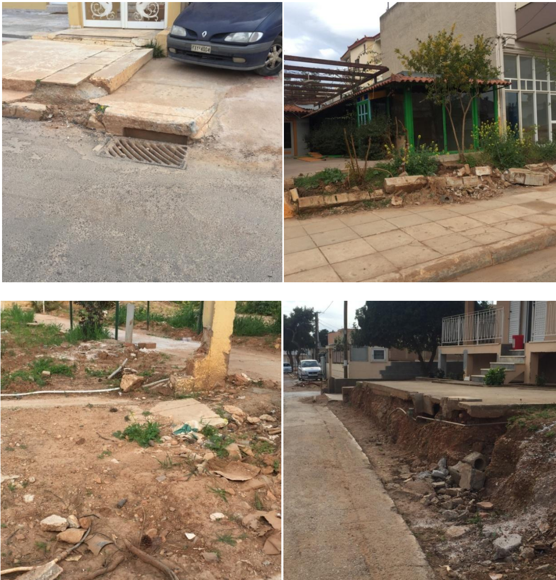
Εικόνα 39 Στοιχεία κακοτεχνίας οδικού δικτύου
