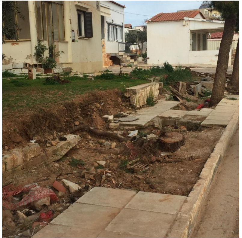
Εικόνα 37 Στοιχεία κακοτεχνίας οδικού δικτύου
