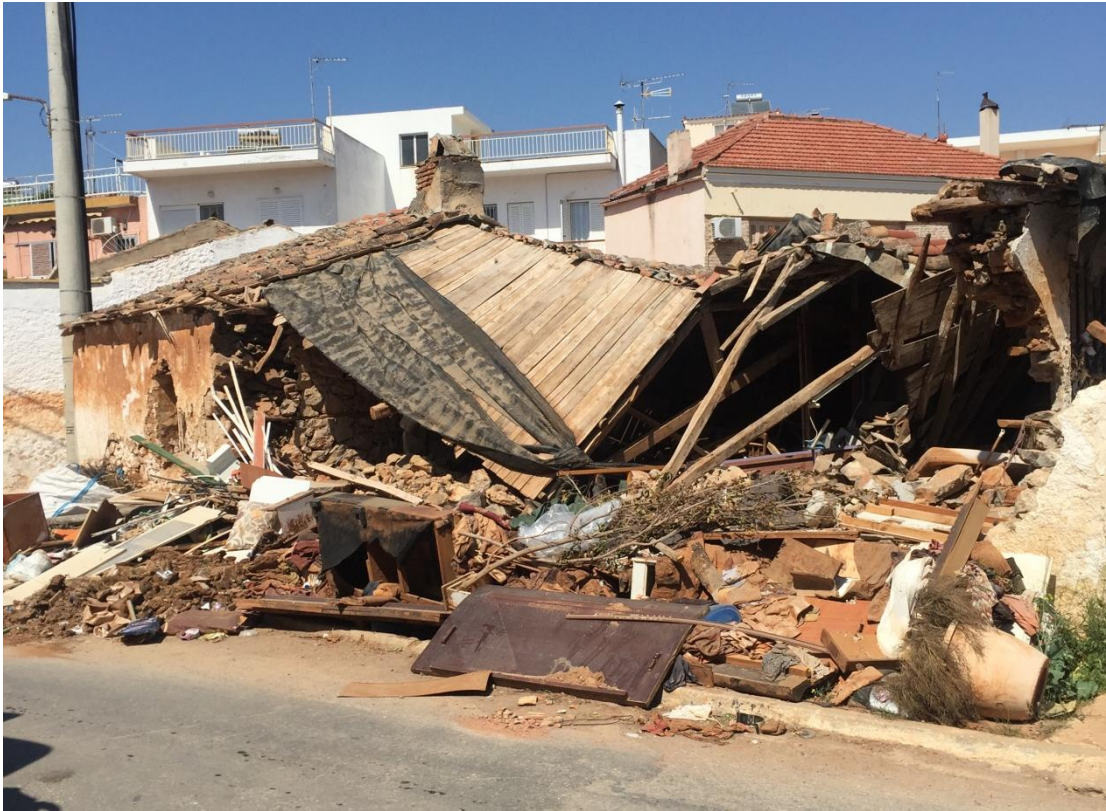
Εικόνα 50 Κατεστραμμένα κτήρια, λόγω παλαιότητας και κακής συντήρησης
