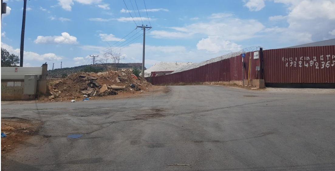
Εικόνα 15 Κακοτεχνίες στο οδικό δίκτυο της ΒΙΠΕ
