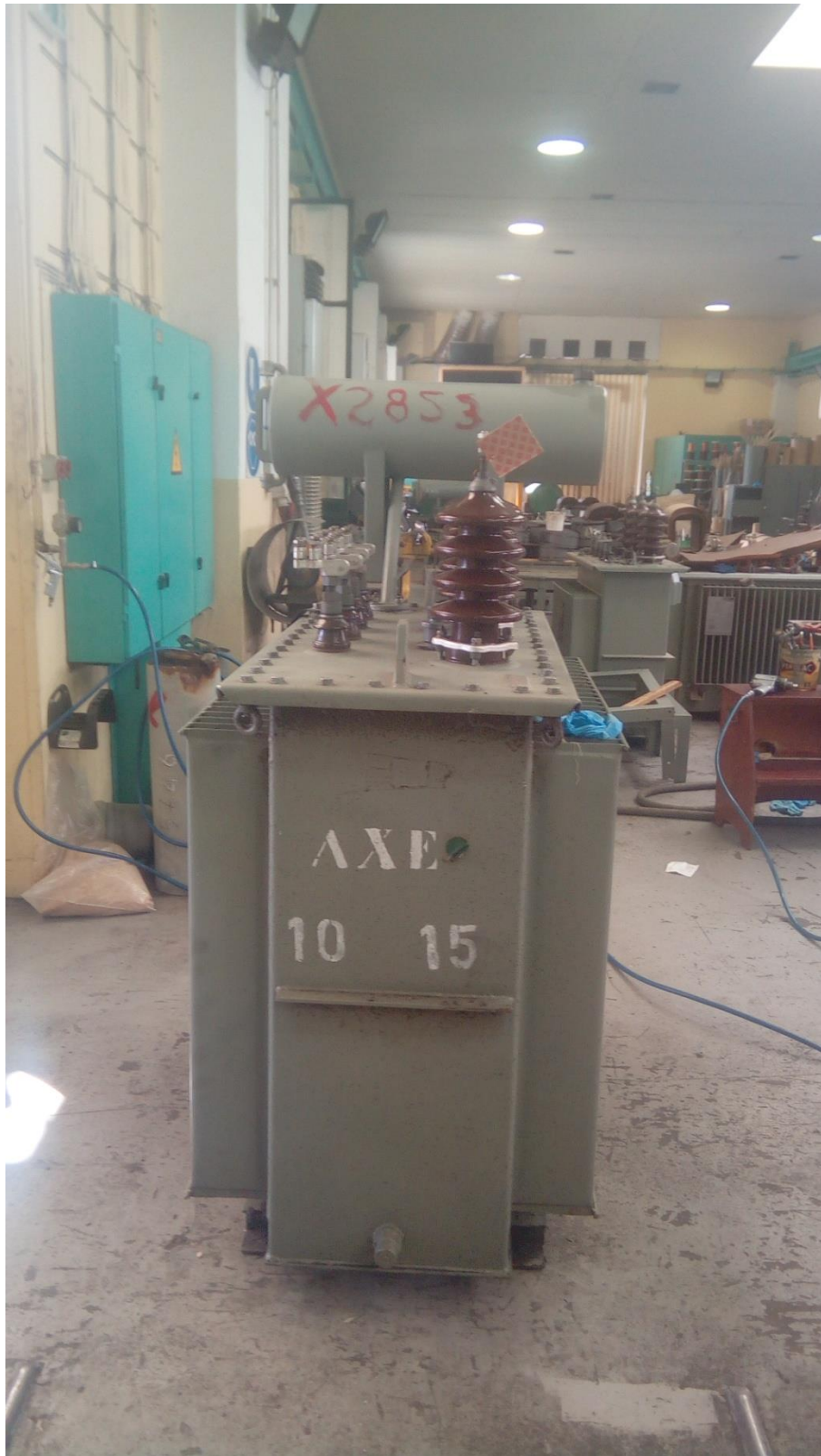
Εικόνα 1.6.2 Μετασχηματιστής ισχύος 20 KV/0,4 KV 150 KVA
