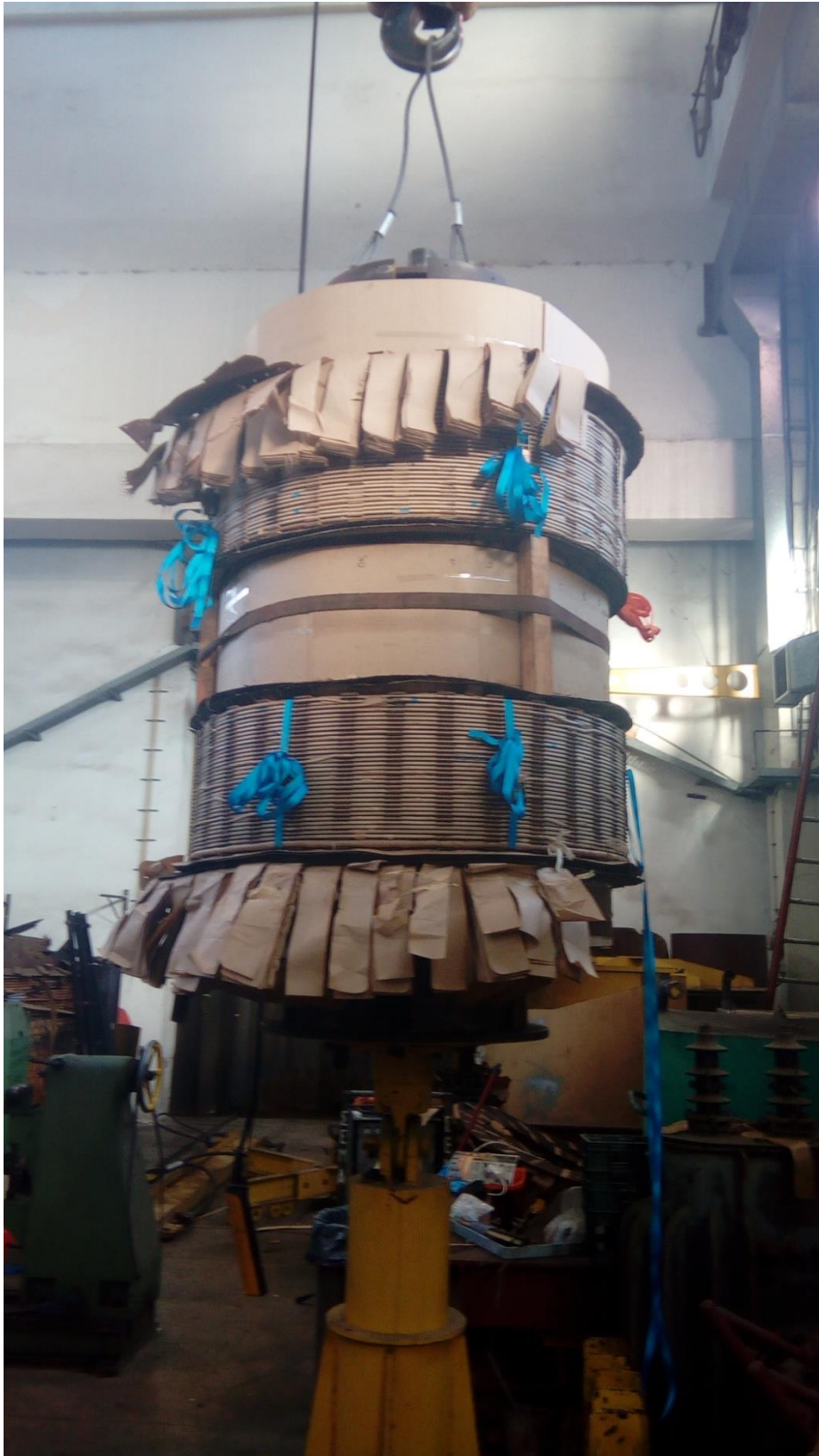
Εικόνα 1.6.4 Πηνίο υψηλής τάσης μετασχηματιστή ισχύος 150 KV/21 KV 25 MVA
