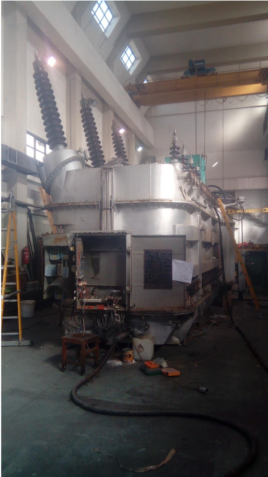
Εικόνα 1.6.3 Μετασχηματιστής ισχύος 150 KV/21 KV 25 MVA
