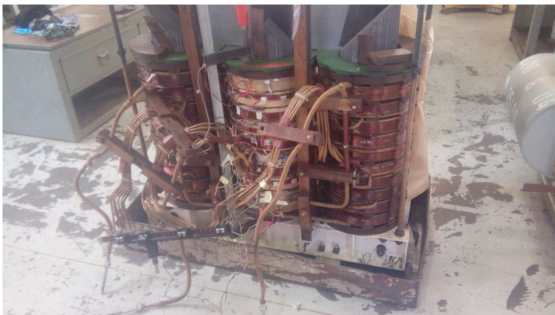
Μετασχηματιστής 20 KV/0,4 KV 630 KVA ανοιγμένος για αντικατάσταση πηνίου μέσης τάσης
