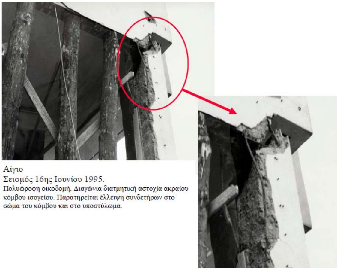
Σχήμα 1.2. Αστοχία κόμβου στο σεισμό του Αιγίου (Καραγιάννης, 2008)
