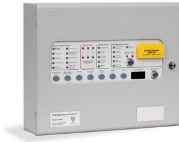
Εικόνα 6.10: Πίνακας πυρανίχνευσης (Πηγή: http://www.firesecurity.gr/kentec_Sigma_xt.html )
