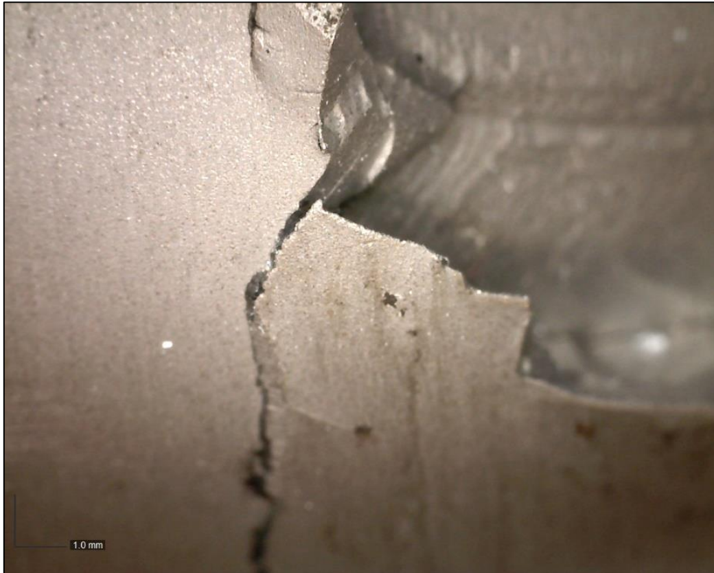
Εικόνα 4.29 Η ρωγμή που ξεκινάει από το σφηνόδρομο.
