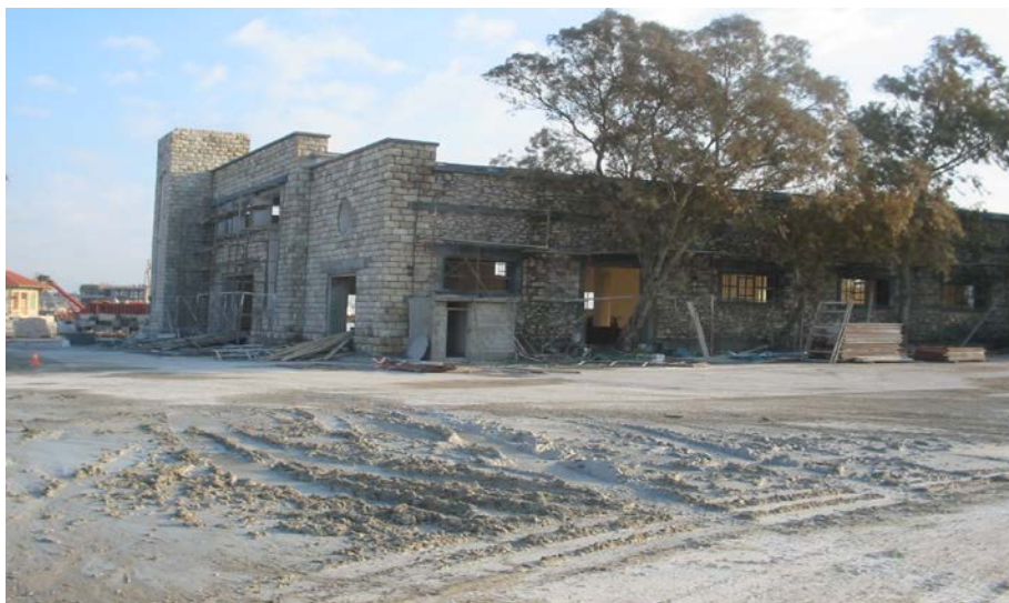
Εικόνα73:Επιβατικός Σταθμός Κανέλου υπό ανακατασκευή. Προέλευση εικόνας: Οργανισμός Λιμένος Πειραιά. Λήψη εικόνας: άγνωστη ημερομηνία.
