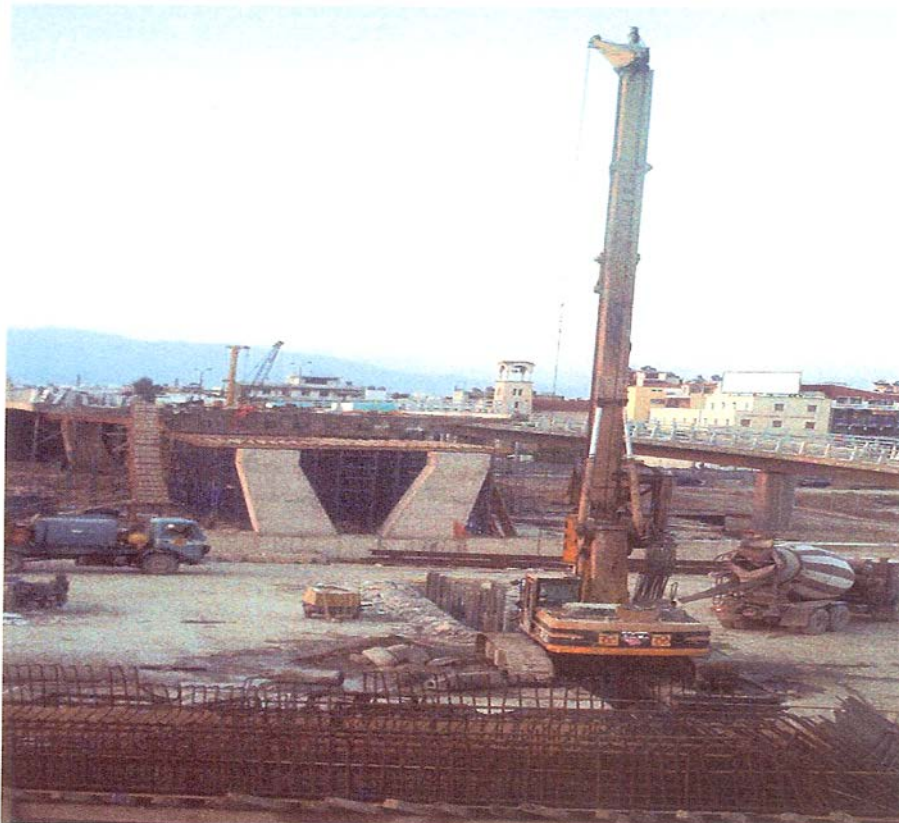
Εικόνα 51: Υπό κατασκευή Ανισόπεδου Κόμβου Κηφισού-Ποσειδώνος. Προέλευση εικόνας: Έλληνες Μελετητές & η Ολυμπιακή Πρόκληση, σελ.235 Λήψη εικόνας: άγνωστη ημερομηνία.
