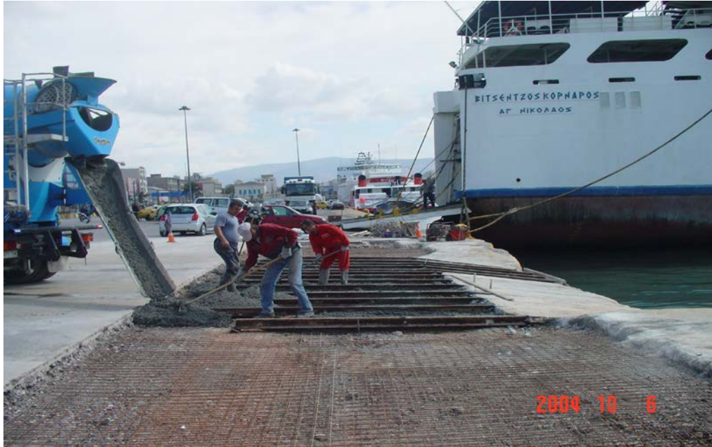
Εικόνα 59:Εργασίες ασφαλτόστρωσης της Ακτής Κονδύλη. Προέλευση εικόνας: Οργανισμός Λιμένος Πειραιά. Λήψη εικόνας:Οκτώβριος 2004.
