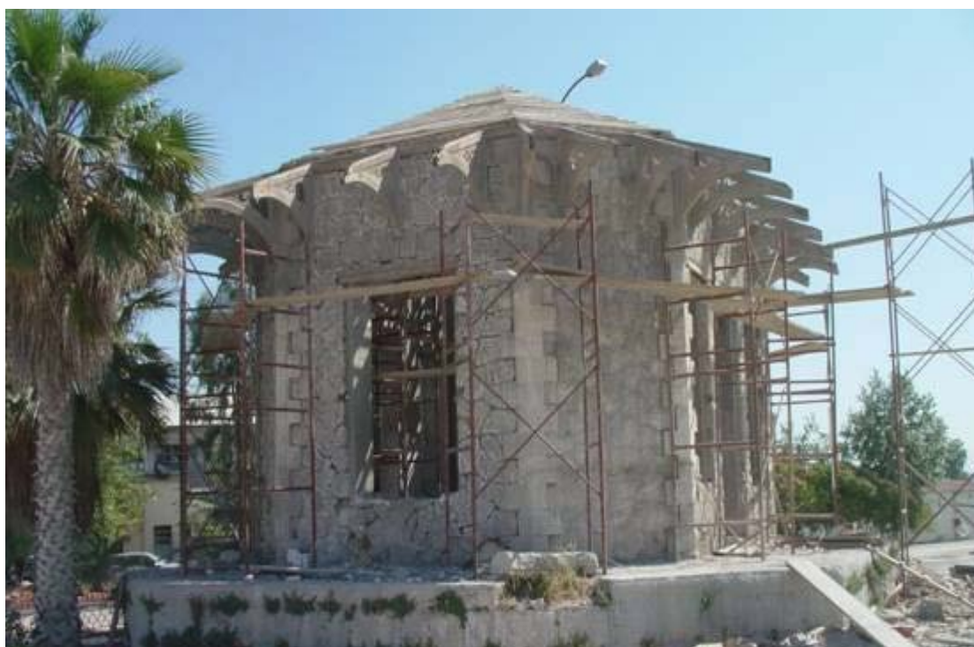
Εικόνα77:Εργασίες αναπαλαίωσης Βασιλικού Περιπτέρου. Προέλευση εικόνας: Οργανισμός Λιμένος Πειραιά. Λήψη εικόνας:άγνωστη ημερομηνία.
