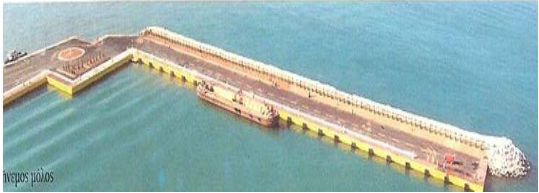
Εικόνα85:Εικόνα εξωτερικού προσήνεμου μόλου. Προέλευση εικόνας: DENCO Σύμβουλοι Μηχανικοί Ε.Π.Ε. Λήψη εικόνας:άγνωστη ημερομηνία.
