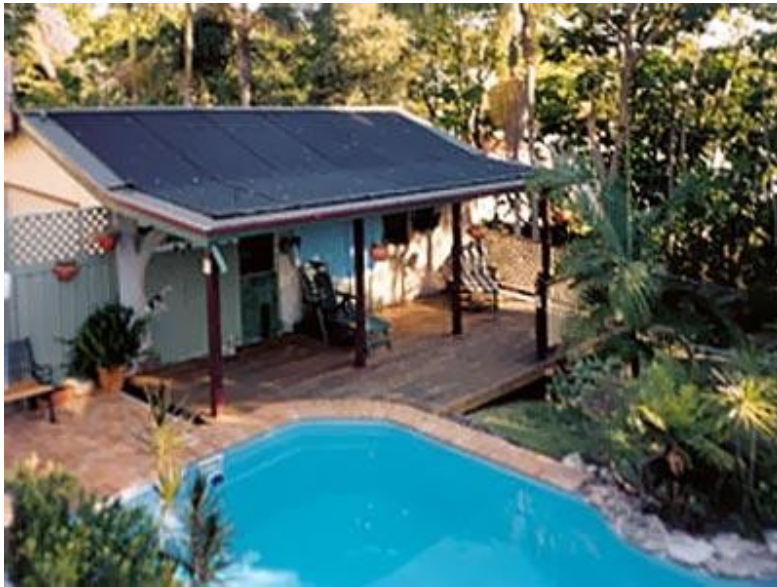
Σχήμα 1.3: Συλλέκτης τοποθετημένος σε στέγη σπιτιού για θέρμανση πισίνας.
