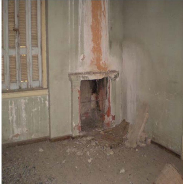
Εικόνα 36:Αποχώρηση τμήματος τζακιού
