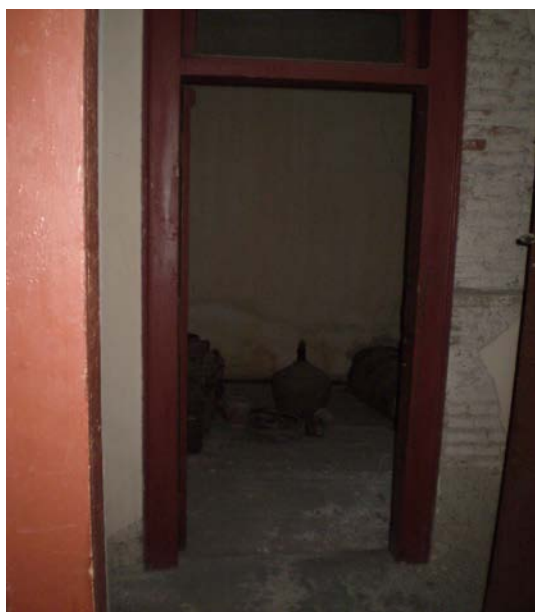
Εικόνα 11:Ο χώρος της τουαλέτας χρησιμοποιείται ως αποθήκη
