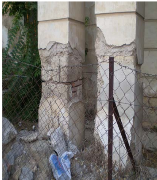
Εικόνα 46: Αποκόλληση σοβάδων και αποκόλληση λιθοδομής διακοσμητικών κολώνων.
