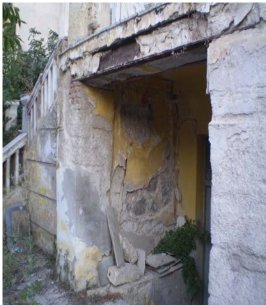
Εικόνα 40: Αποκόλληση τμήματος τοιχοποιίας απογύμνωση της λιθοδομής
