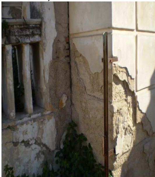
Εικόνα 45: Αποκόλληση γωνιακού τμήματος σοβά και τοιχοποιίας.
