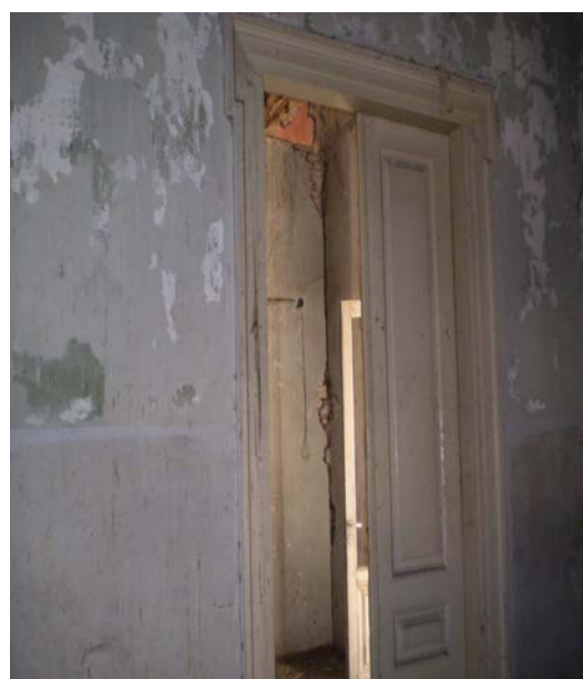
Εικόνα 35:Αποκόλληση εξωτερικών επιχρισμάτων.
