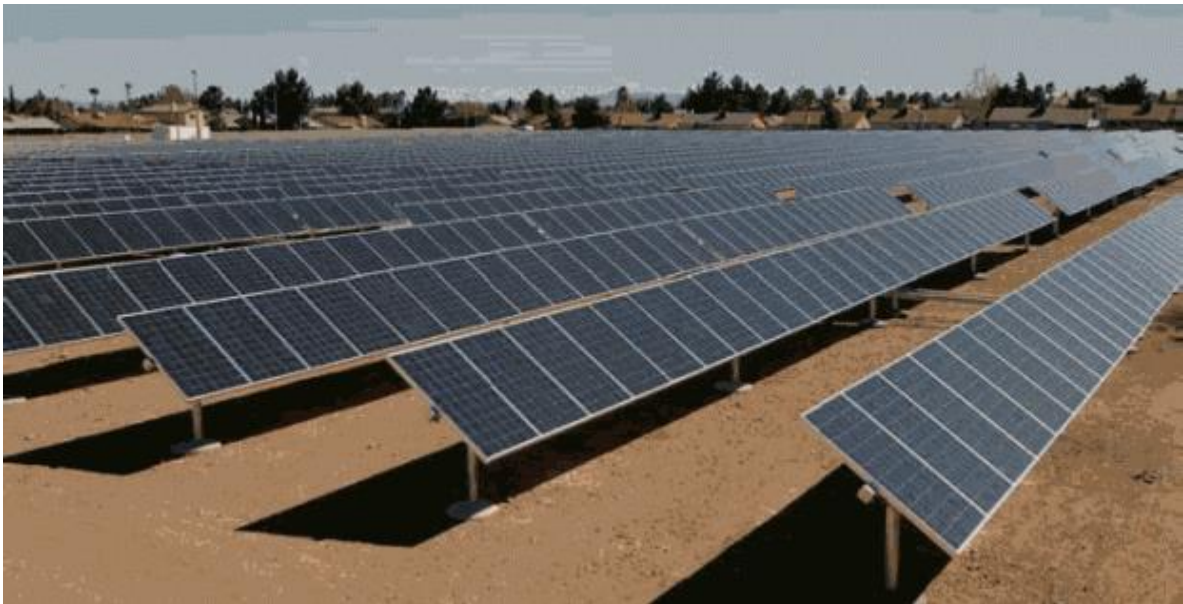
Σχήμα 6.2.1: Φωτοβολταϊκό πάρκο λεπτών υμενίων (Τουρκία)
