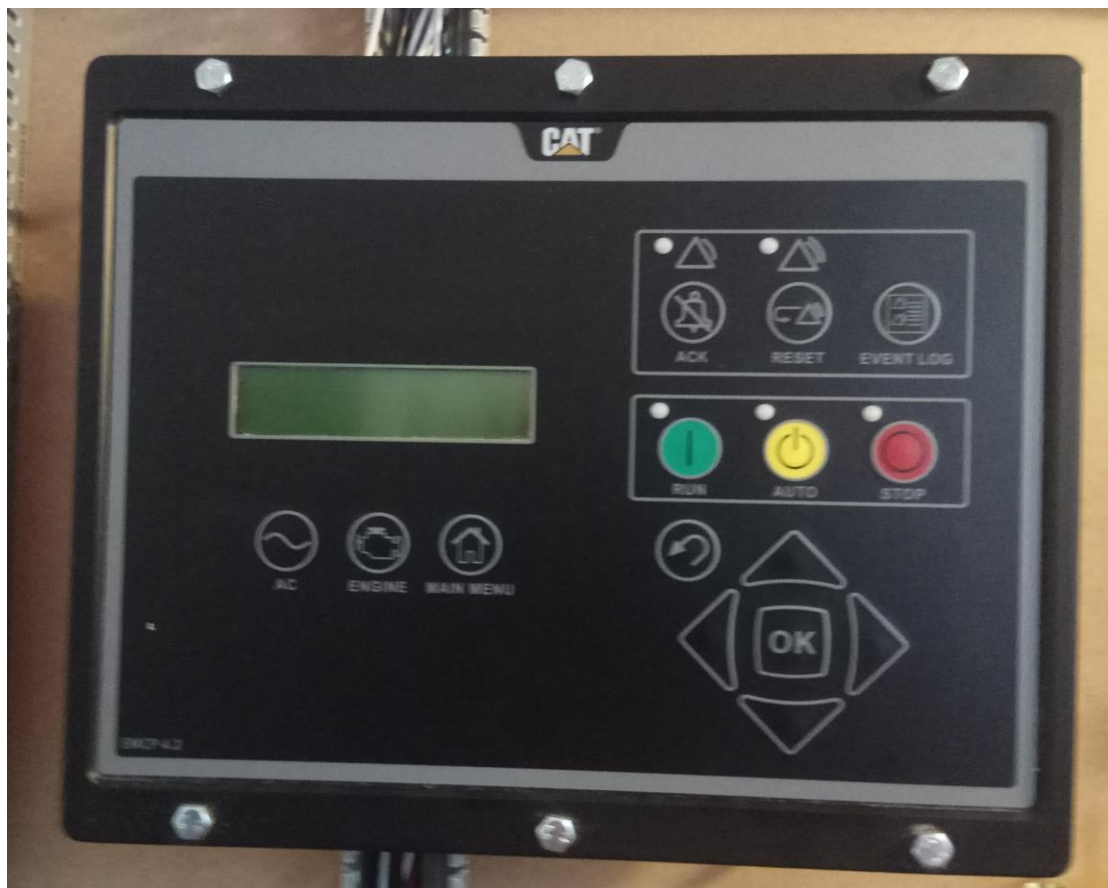
Εικόνα 25 Πίνακας ελέγχου Η/Ζ
