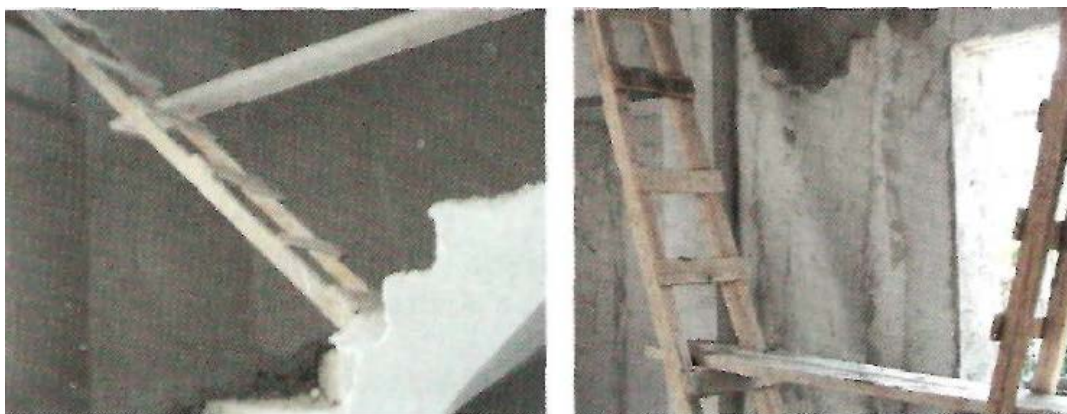
Λάθος και ανασφαλής χρήση φορητών κλιμάκων για έδραση δαπέδων εργασίας
