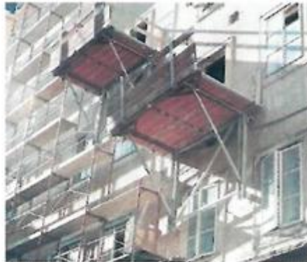
Δάπεδα εργασίας. Πλήρες μαδέρωμα - προστασία έναντι πτώσης. Πλήρες μαδέρωμα - ελλειπής προστασία έναντι πτώσης
