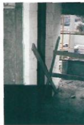
Απαραδέκτη προστασία ανοίγματος ανελκυστήρα
