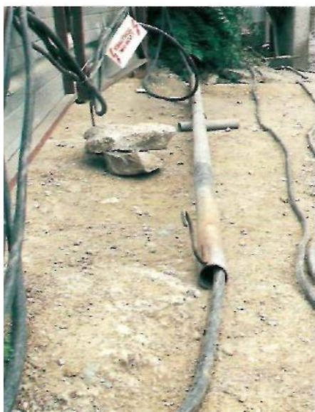
Προστασία καλωδίων από μηχανική φθορά.
