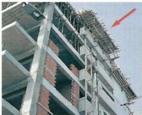
Σκαλωσιές εξωτερικών τοιχείων χωρίς προστασία έναντι πτώσης.
