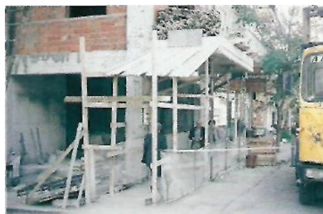
Προστατευτικό προστέγασμα με ακατάλληλη - επικίνδυνη κλίση.
