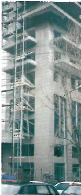
Εξώστες χωρίς προστασία έναντι πτώσης. Ιδιαίτερος κίνδυνος στους εξώστες που καταλήγει το αναβατόριο.
