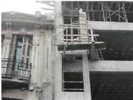
Ασφαλές διπλό λατάκι αριστερά. Δάπεδο εργασίας προστατευμένο μερικώς έναντι πτώσης. Ασφαλέστερα τα μαδέρια αντί πλακάς.
