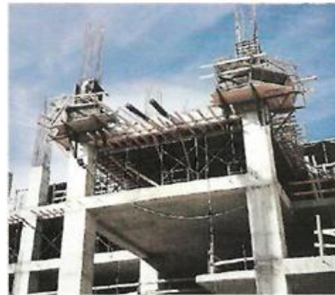
Ασφαλής σκαλωσιές εξωτερικών τοιχείων και στύλων.
