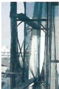
Ανασφαλή δάπεδα εργασίας (απαιτείται και δεύτερο μαδέρι)
