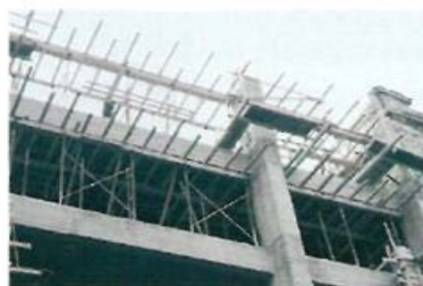
Δάπεδα εργασίας ασφαλή στο σχεδιασμό τους. Συμπλήρωση στην προστασία έναντι πτώσης. Αντικατάσταση των πλακάς με μαδέρια.
