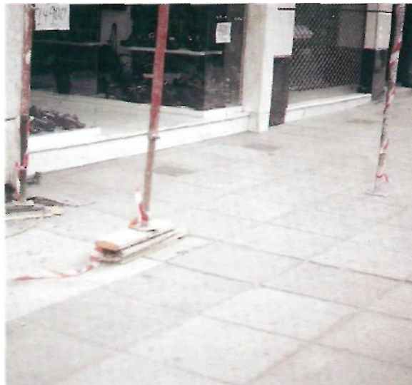
Απαράδεκτη έδραση σκαλωσιάς (δύο ορθοστάτες αριστερά). Ορθή έδραση (ορθοστάτης δεξιά).
