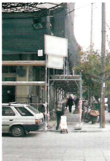
Ασφαλής διέλευση κάτω από τη σκαλωσιά.
