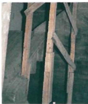
Καλή προστασία στο φανάρι (κουβάς) κλιμακοστασίου
