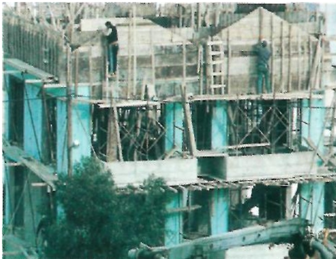
Ανασφαλής χρήση φορητής σκάλας σε εξωτερικό δάπεδο εργασίας, απροστάτευτο έναντι πτώσης
