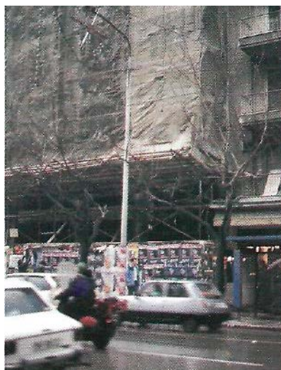
Περίφραξη - Άδεια κατάληψης πεζοδρομίου από το Δήμο. Σκαλωσιά με κάλυψη και προστατευτικό προστέγασμα.
