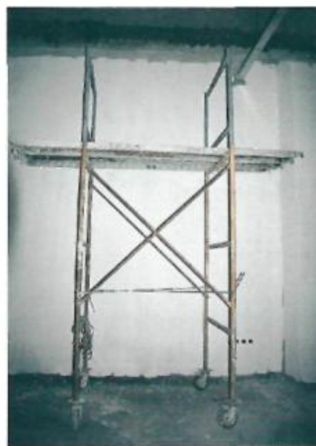
Κινητή σκαλωσιά (πύργος) ανασφαλής. - Δάπεδο εργασίας χωρίς προστασία έναντι πτώσης - Δεν υπάρχει σκάλα για ανασφαλή ανάβαση - κατάβαση.
