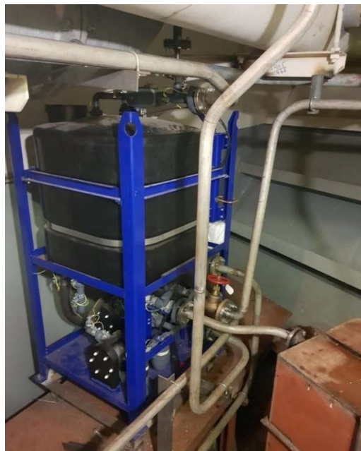
Εικόνα 115: Τοποθέτηση συστήματος αυτό-καθαρισμού “CIP”.
