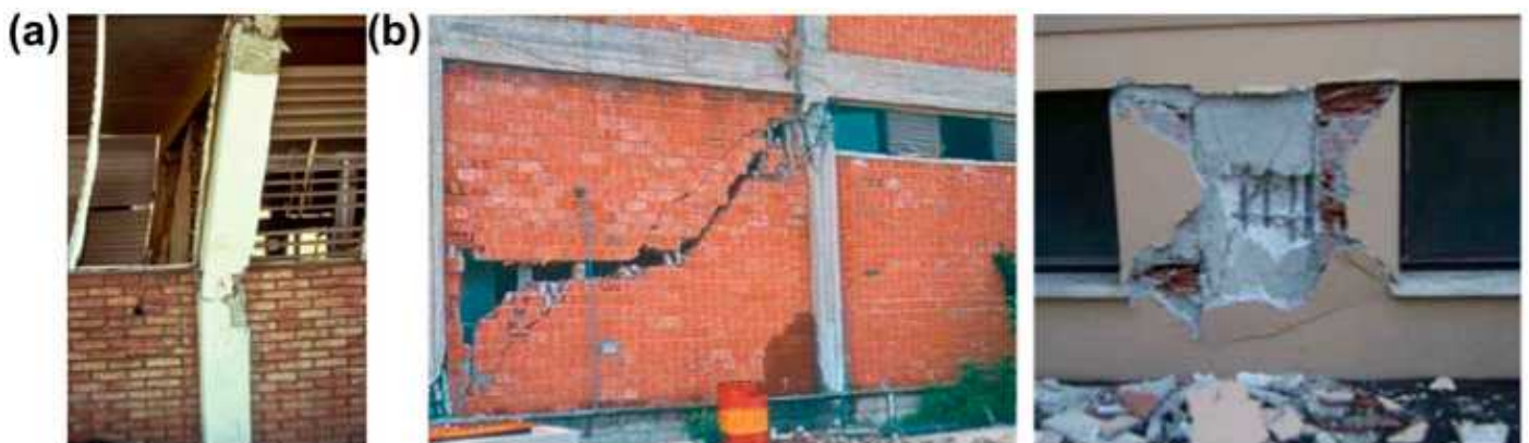
Σχήμα 2-3: Επιδράσεις αλληλεπίδρασης πλαισίου-τοιχοπλήρωσης: τοπική κατάρρευση λόγω του διαφορετικού ύψους υποστυλώματος - πλήρωσης: (α) μηχανισμός διπλής πλαστικής άρθρωσης κοντού υποστυλώματος, (β) αστοχία διάτμησης κοντού υποστυλώματος (Koutromanos et al., 2011)
