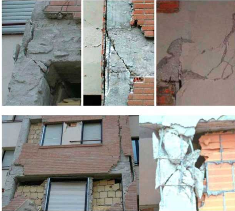
Σχήμα 2-2: Επιδράσεις της τοπικής αλληλεπίδρασης πλήρους πλαισίου: Δείγμα τοπικής διάτμησης των άκρων των κολώνων και των κόμβων λόγω της αλληλεπίδρασης με τις τοιχοπληρώσεις. (Koutromanos et al., 2011)
