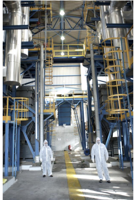
ii. Το εσωτερικό της μονάδας καύσης.
