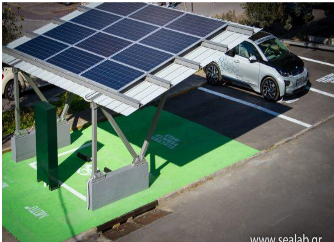
Εικόνα 45: Υβριδικός σταθμός φόρτισης ηλεκτροκίνητων οχημάτων Carport
