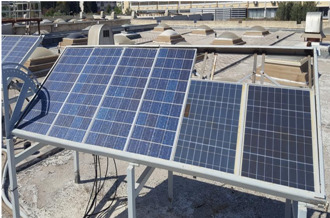
Εικόνα 40: Φωτοβολταϊκή εγκατάσταση (Kyocera-Phaesun) στην οροφή του κτηρίου Γ.
