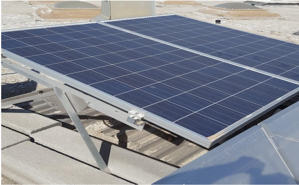
Εικόνα 43: Φωτοβολταϊκή εγκατάσταση (Aleo) στην οροφή του κτηρίου Γ.
