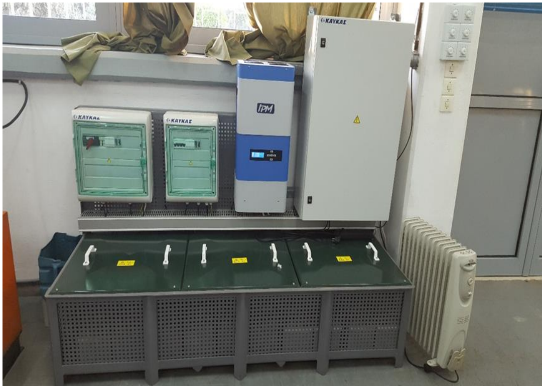
Εικόνα 49: Τμήματα της εγκατάστασης του Carport (πίνακες ελέγχου, συσσωρευτές κτλ.).
