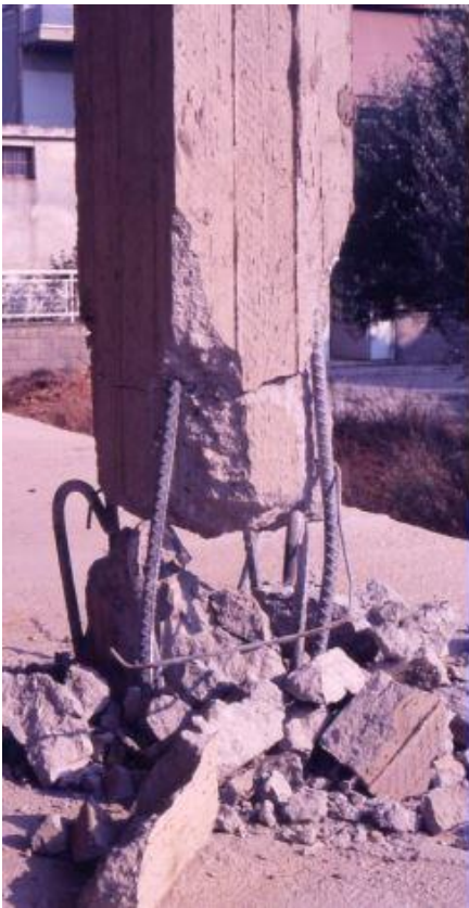
Εικόνα 1: Εμφανείς βλάβες σε υποστύλωμα
