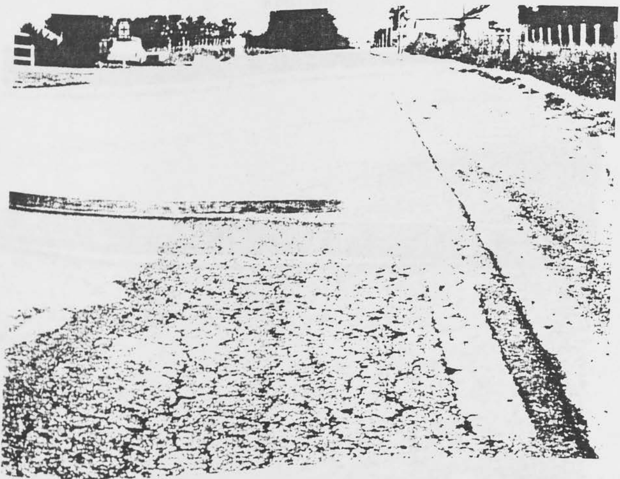
Καθίζηση στο άκρο του οδοστρώματος
