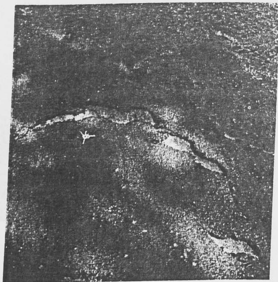
Λεπτομέρεια ρωγμής ολίσθησης
