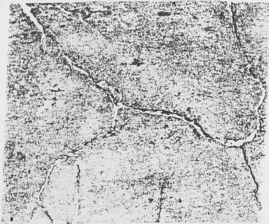
Ρωγμές συστολής. Λεπτομέρεια.
