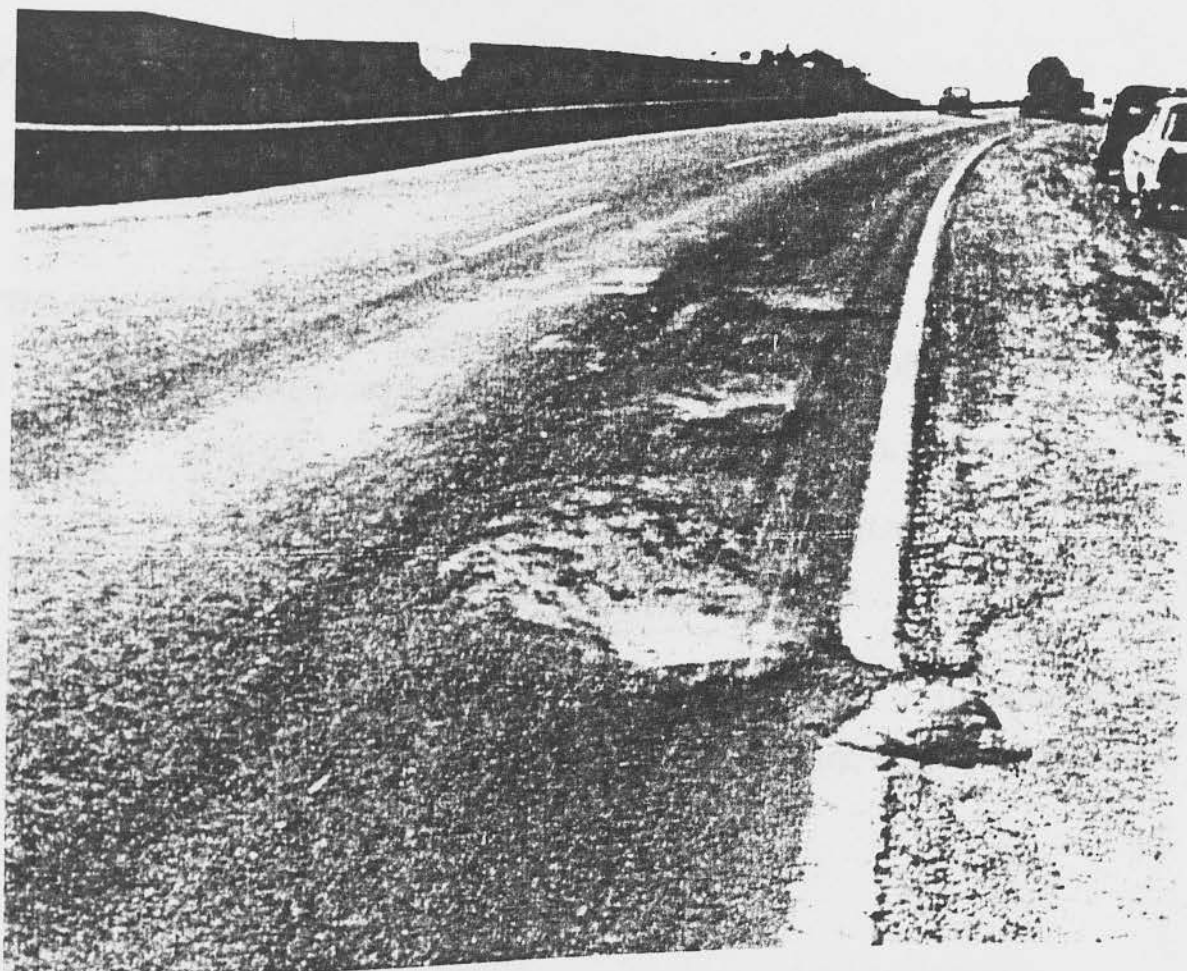
Τοπική διόγκωση στην άκρη του οδοστρώματος
