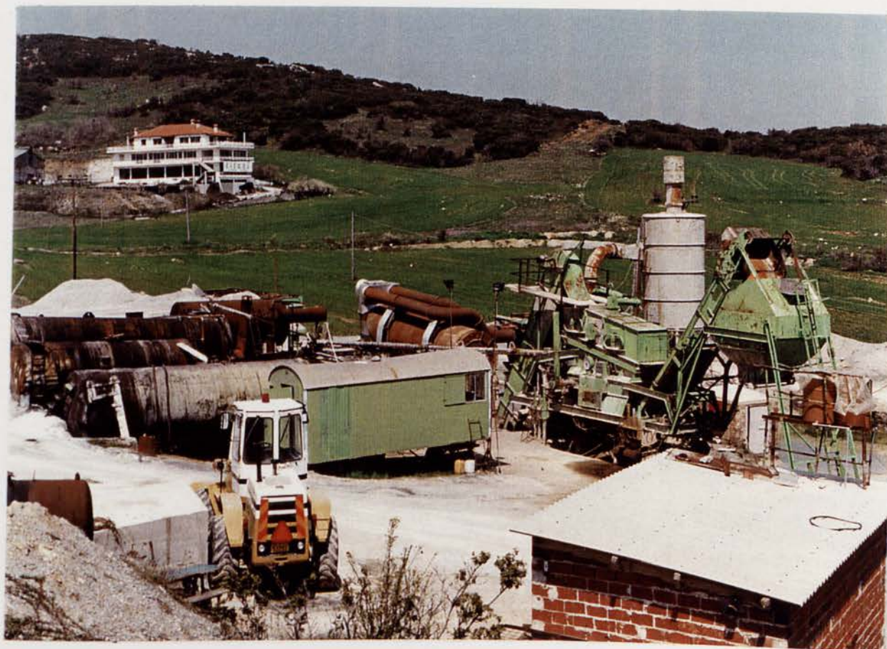
Συγκρότημα παραγωγής ασφαλτομίγματος συνεχούς ροής
